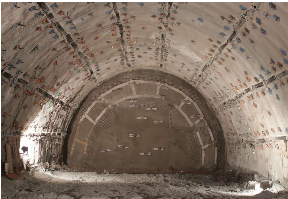
Abb. 2.9: Vortrieb in stark druckhaftem Gebirge unter dem Einsatz von acht Reihen Stauchelementen in einem Tunnel in Österreich (Quelle: Eigene Abbildung)
