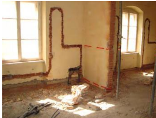
Abbildung 172 Bauteilaktivierung mit Rohrführung in den Klosterräumen (Knotzer, Armin; AEE intec, 2011), S. 39)
