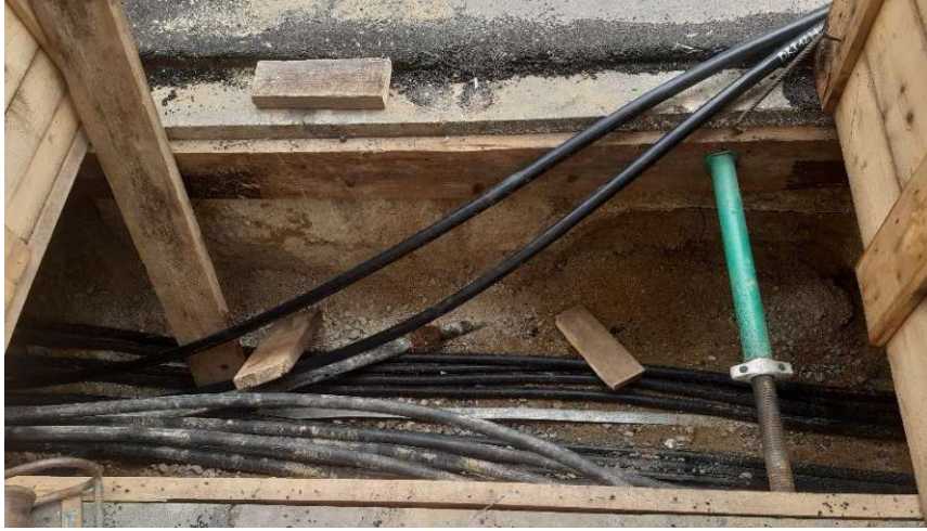
Abbildung 88 Schacht am Gehsteig bei der Kreuzung Wiedner Hauptstraße, Ecke Paulanergasse mit verschiedenen infrastrukturellen Leitungen (Foto von 25.09.2023) (Lang D. J., 2023)
