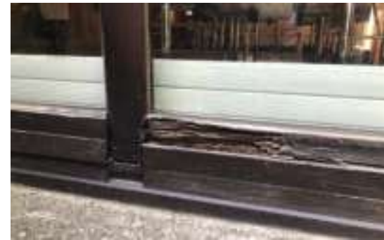
Abb.60-61 Stark verwittertes Holz-Fensterprofil der ehemaligen Gruppenräume in südöstlicher Richtung von der Westfassade vor der Sanierung. Aufnahme datum März 2022.
