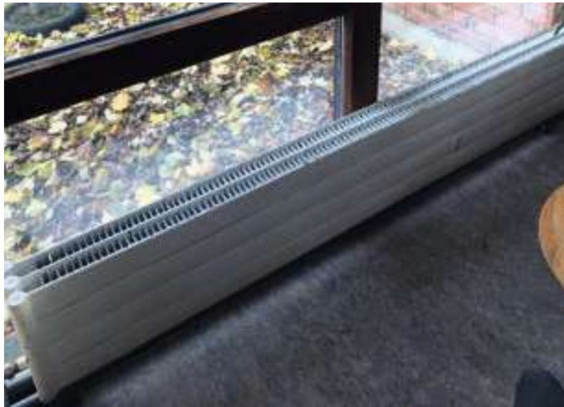
Abb.117 Niedrige Heizkörper, die vor der raumhohen Holz-Glas-Fassade positioniert sind und noch aus der Zeit stammen, als das Gebäude als Kindergarten diente, sorgen immer noch für die Beheizung der Räume.
