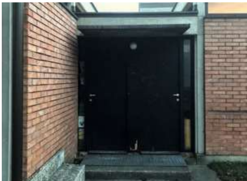
Abb.101 Ehemalige Wohnungseingangstüren an der Nordfassade sind dunkelbraun lackiert, bestehen aus Holz und verfügen über metallene Türgriffe.
