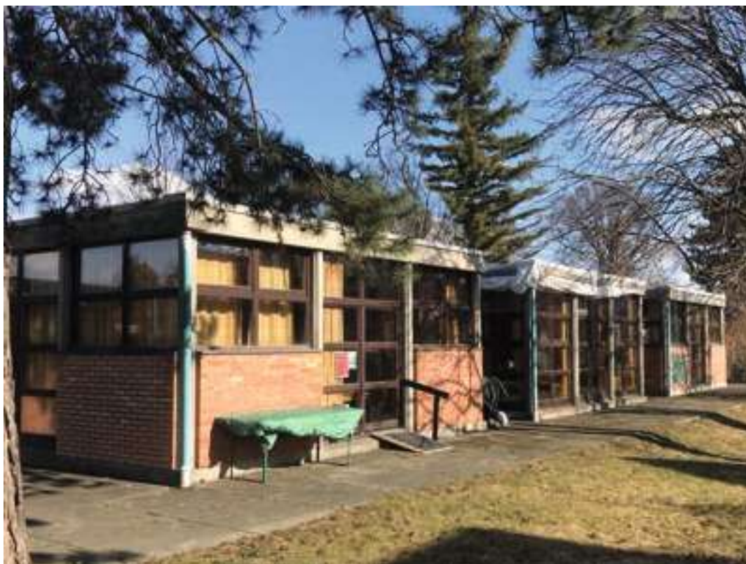
Abb.56 Blick auf die Südfassade. Planabdeckung auf dem Dach des ehemaligen Bewegungsraums vor der Sanierung. Aufnahme datum März 2022.
