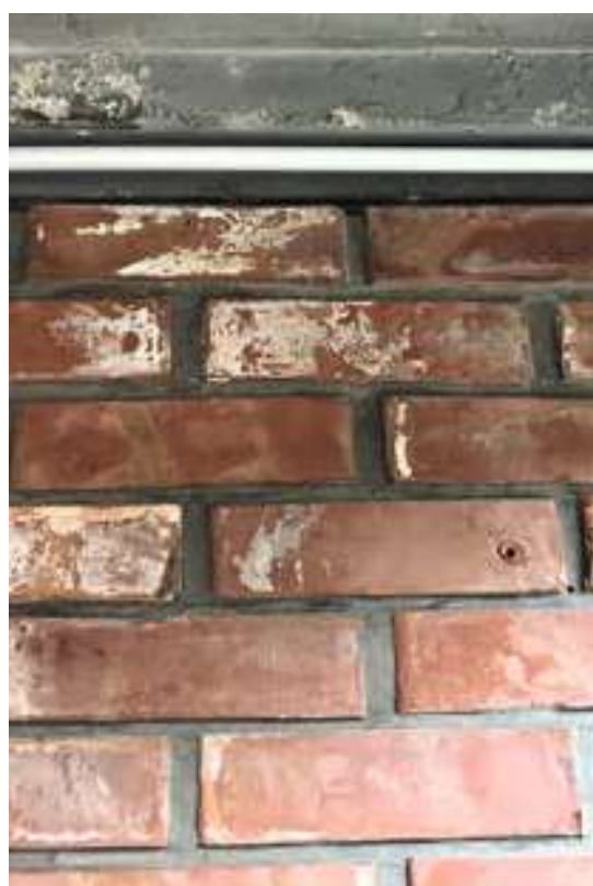
Abb.125-126-127 Sichtziegelwände die deutliche Anzeichen von weißen Salzausblühungen aufweisen.
