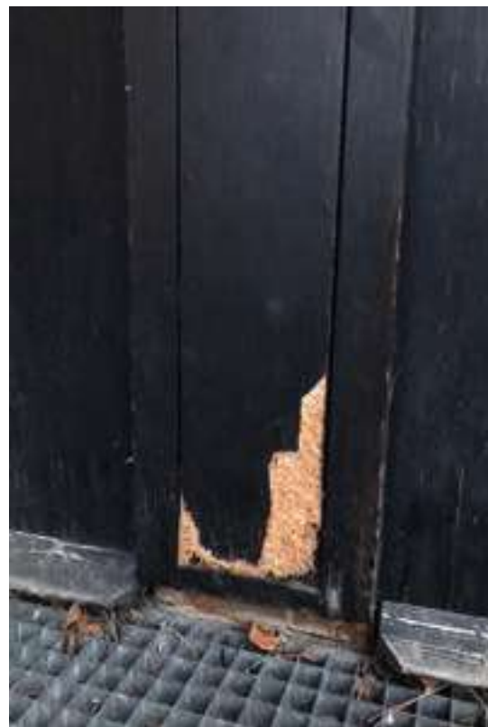
Abb.128-129 Die dunkelbraun lackierten Holztüren an der Nordfassade zeigen Witterungsschäden und Sprödigkeit im Bereich des Spanholzes und bedürfen daher einer Reparatur.
