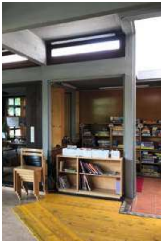
Abb.65 Boden des ehemaligen Gruppenraums in südöstlicher Richtung vor der Sanierung. Aufnahme datum März 2022.
