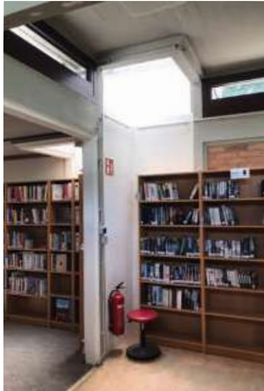
Abb.119 Die Lichtkuppel über dem ehemaligen Verteilungsraum der nordwestlichen Wohnung wurde in ihrer Wirkung durch den nachträglichen Einbau von Trennwänden darunter beeinträchtigt, was zu einer signifikanten Beeinträchtigung der ursprünglichen architektonischen Harmonie und Qualität des Raumes führte.
