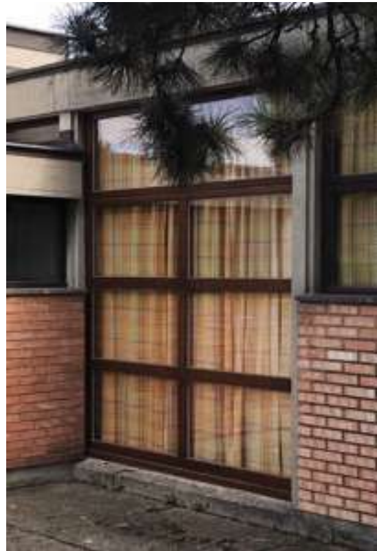
Abb.62 Holz-Fensterprofil der ehemaligen Gruppenräume in südöstlicher Richtung von der Westfassade nach der Sanierung. Aufnahme datum September 2023.
