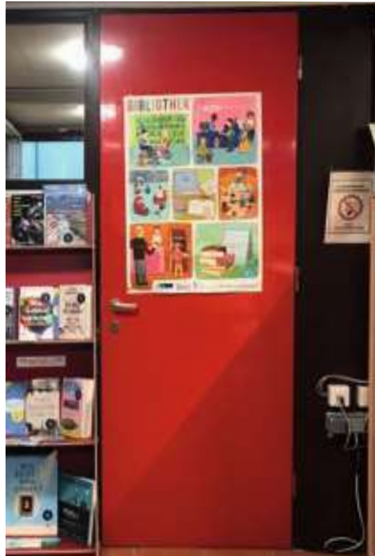
Abb.121 Die neuen Türen für die Personaleinheit und den kleinen Therapieraum sind vorgesehen, in Anlehnung an die rot lackierten Holztüren ohne Glasscheibe aus der Bauzeit, montiert zu werden
