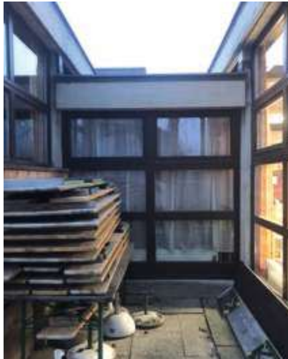
Abb.89 Blick auf den Zwischenraum an der Südfassade, der sich zwischen dem ehemaligen Bewegungsraum und dem südwestlichen ehemaligen Gruppenraum befindet
