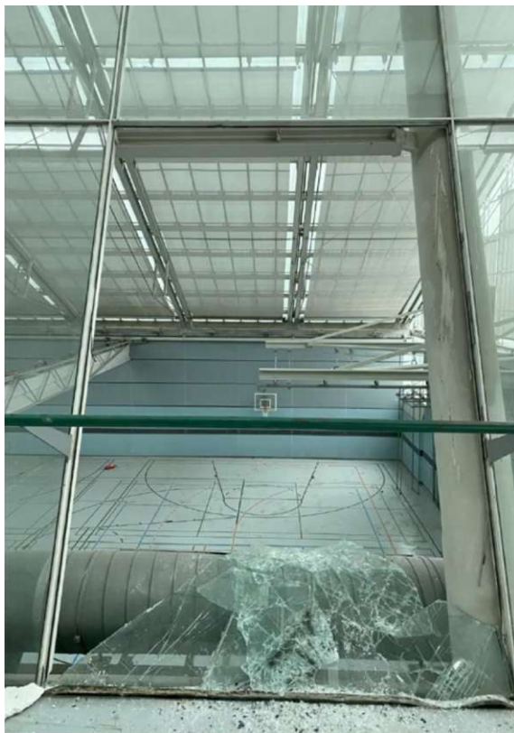
Abb. 106: zerstörte Scheibe im Erschließungsgang
