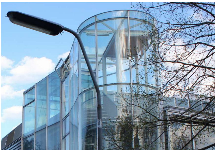
Abb. 104: dauerhaft geöffnetes Fenster im Fluchtstiegenhaus
