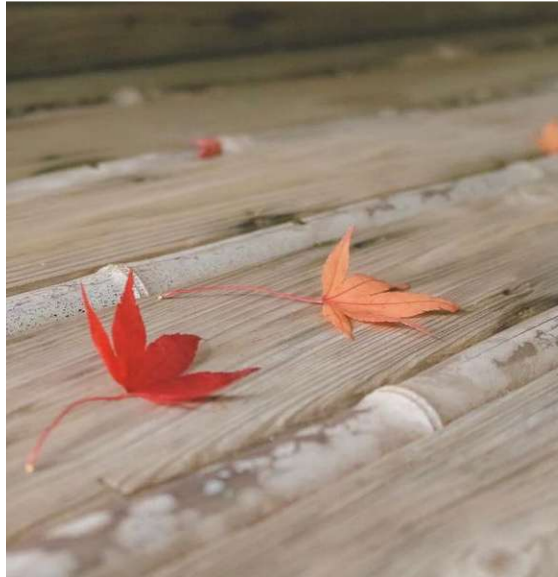
263 Detail der Veranda: Bambusstäbe befinden sich zwischen einzelnen Holzbrettern; entspricht der wabi -Ästhetik.
