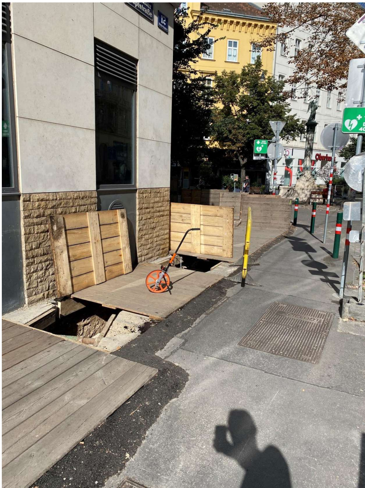
Abbildung 22 Unzureichend abgesicherte Baustelle im Bereich der Hausfassade Quelle: Eigene Aufnahme.
