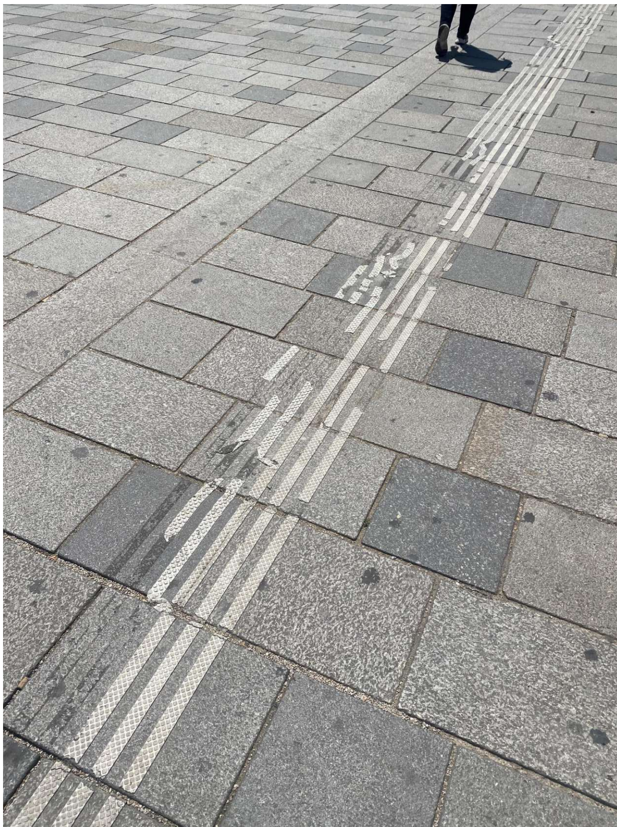
Abbildung 16 Eingeschränkte Nutzbarkeit der aufgeklebten Leitlinien auf Granitplatten durch Beschädigungen und Unvollständigkeit der Leitlinien Quelle: Eigene Aufnahme.
