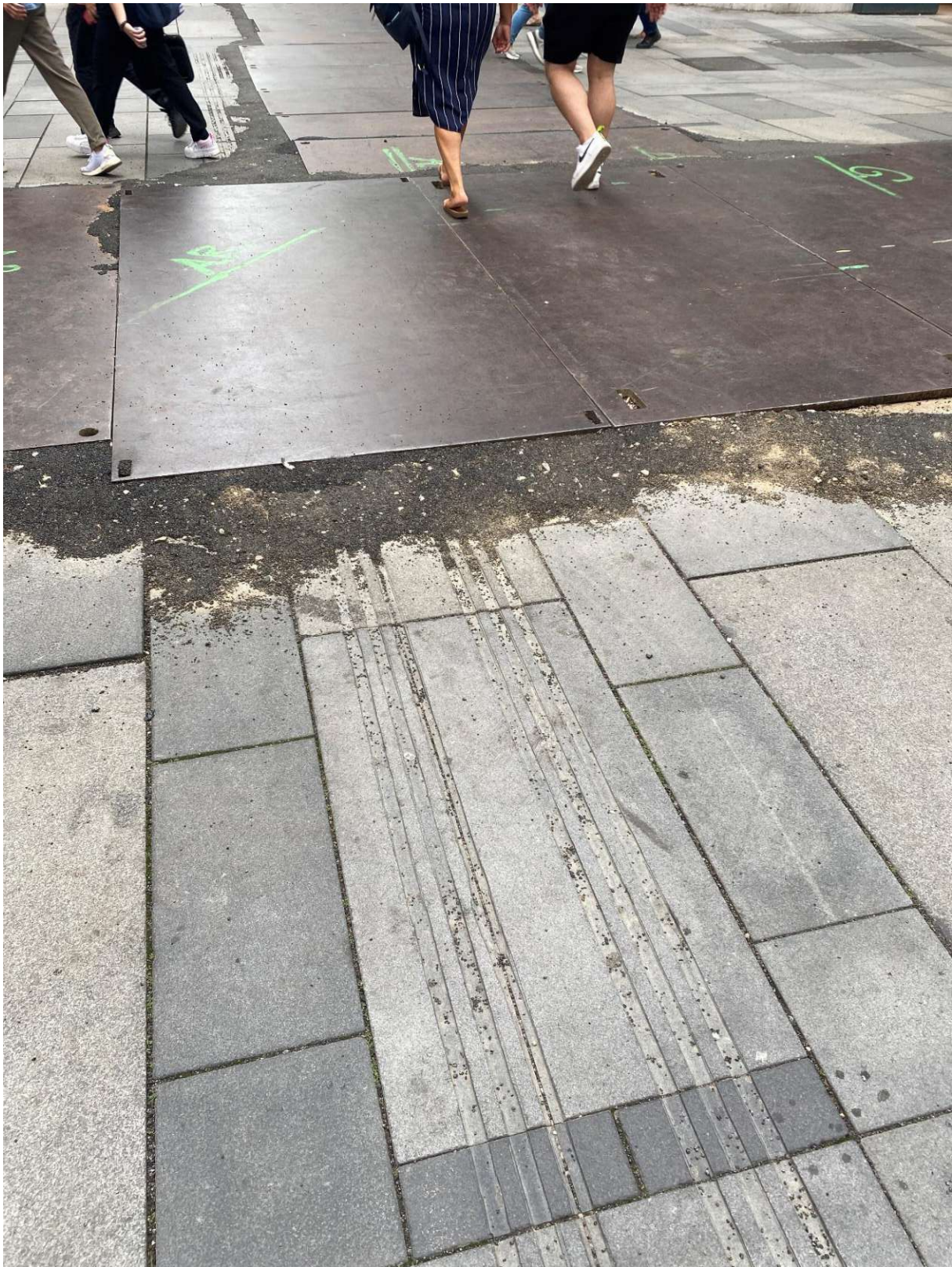
Abbildung 17 Unterbrochene Leitlinien durch Baustellenabdeckungen und Schaffung einer Stolperfalle Quelle: Eigene Aufnahmen.
