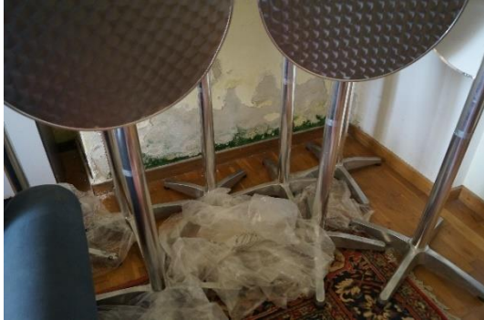
Abb. 3.2.17: Feuchteschäden, Wohnzimmer im Erdgeschoß, Pfarrhaus Winden am See.
