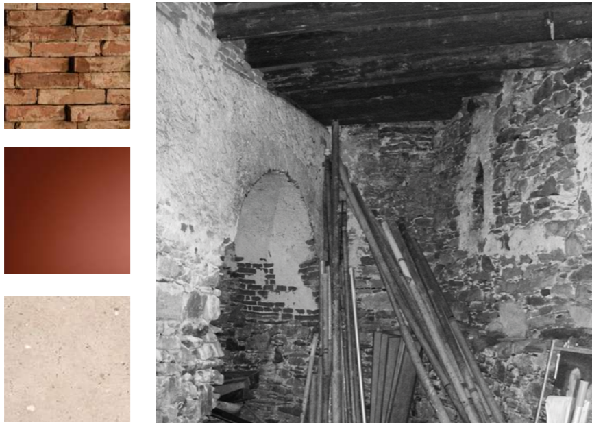
Abb.86: Collage Materialien Neu im Lagerraum
