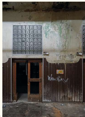
Abb. 182 | Zustand der Wände des Hauptsahls, 2023
