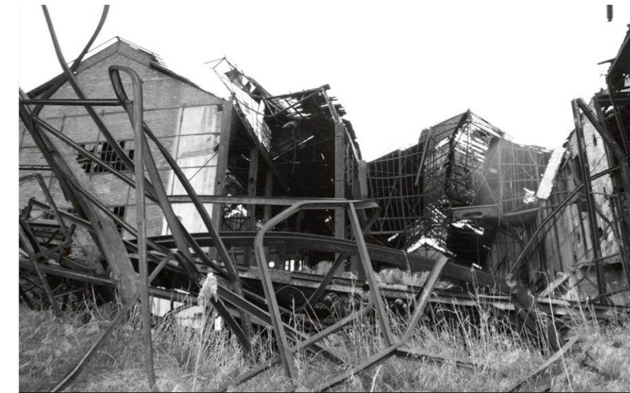
Abb. 4.2.1: Ausblick auf den verfallenen Bauabschnitt
