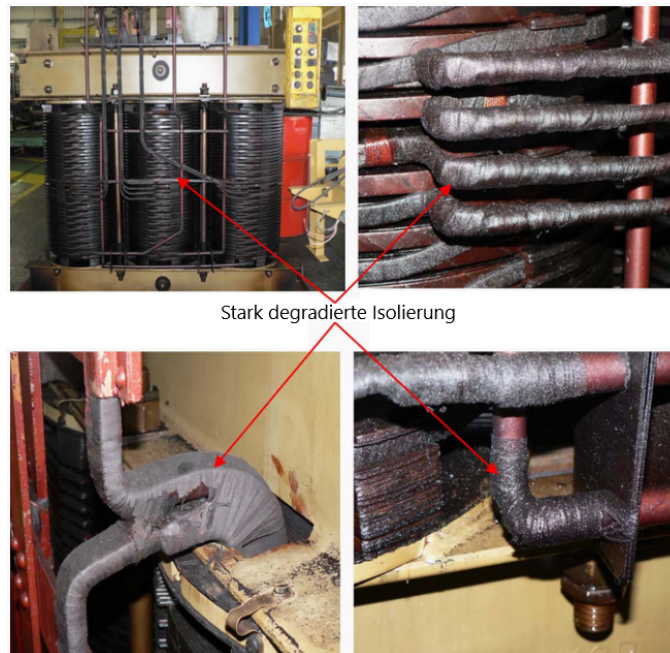
Abbildung 4.13: Gealterte Isolierung in einem alten Transformator, Foto: I.A.R. Gray; Transformer Chemistry Services
