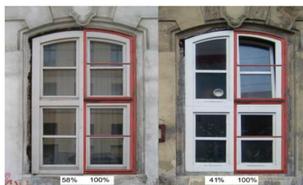
1030, Weißgerberstraße 30. Extremster Verlust an Glasfläche! Links: nur noch 58% Glasfläche nach dem Tausch. Rechts: nur noch 41% Glasfläche nach dem Tausch. Falsche Profilstärke, falsche Konstruktion. Rot: Originalflügel (Fotomontage, rote Farbe zur besseren Erkennbarkeit), 100% Glasfläche.
