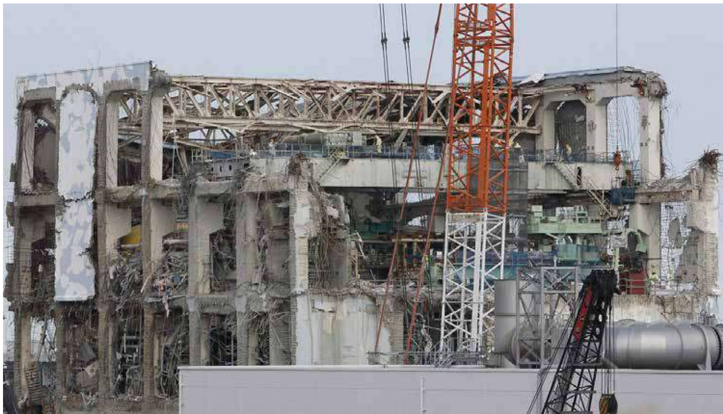
Abb. 115, Zerstörter Reaktor des Atomkraftwerks Fukushima Daiichi
