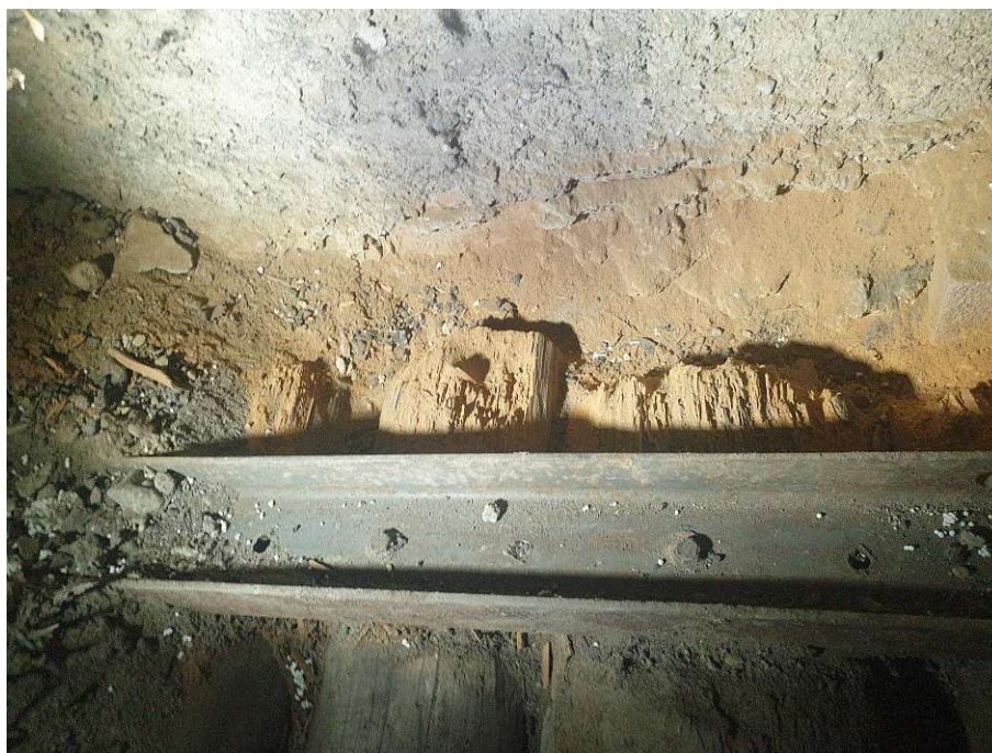
Abb. 2.28: Schäden zufolge Feuchtigkeit im Auflagerbereich (eigene Aufnahme)
