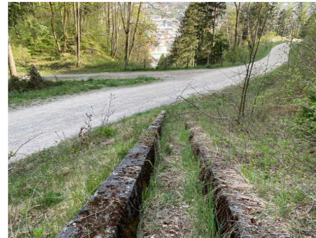
Abb. 35 Kreuzung ehemaliger Trasse mit Fussweg auf die Hungerburg und Weg zum Spielplatz
