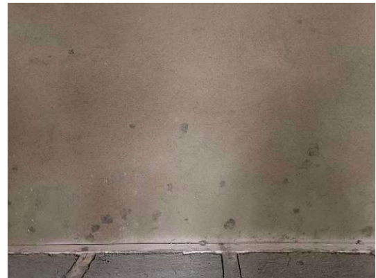
Abb. 5.14 | Schadensbild bei organischen Bestandteilen im Putz
