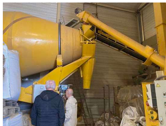
Abb. 3.20 | Mischanlage und Abfüllung
