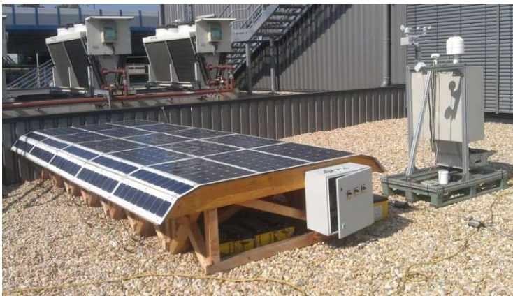
(a) Aufbau Projektanlage, Copyright: Siemens
