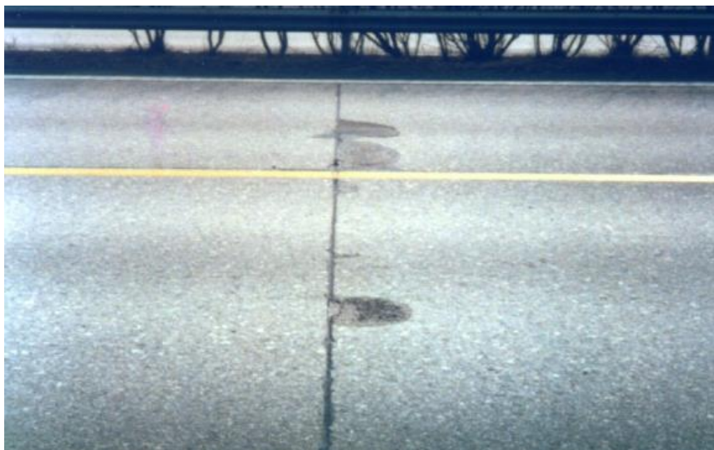
Abb. 2: Kantenschäden an einer Betonfahrbahn [5]
