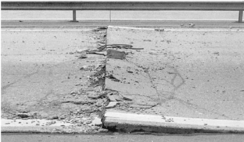
Abb. 1: "Blow Up" an einer Betonfahrbahn [5]
