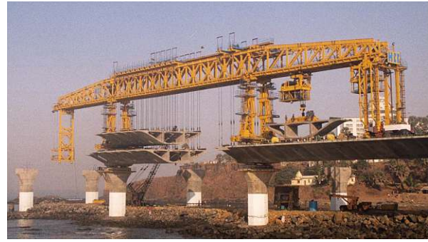
(b) Feldweise Errichtung eines Spannbetonhohlkastens mittels Fertigteilsegmenten und obenliegendem Versetzträger [9], © VSL International
