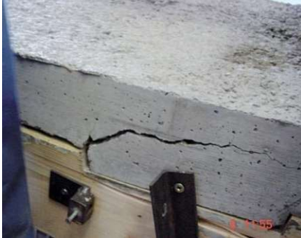
Abb. 2-30: Konsolversagen des Beton
