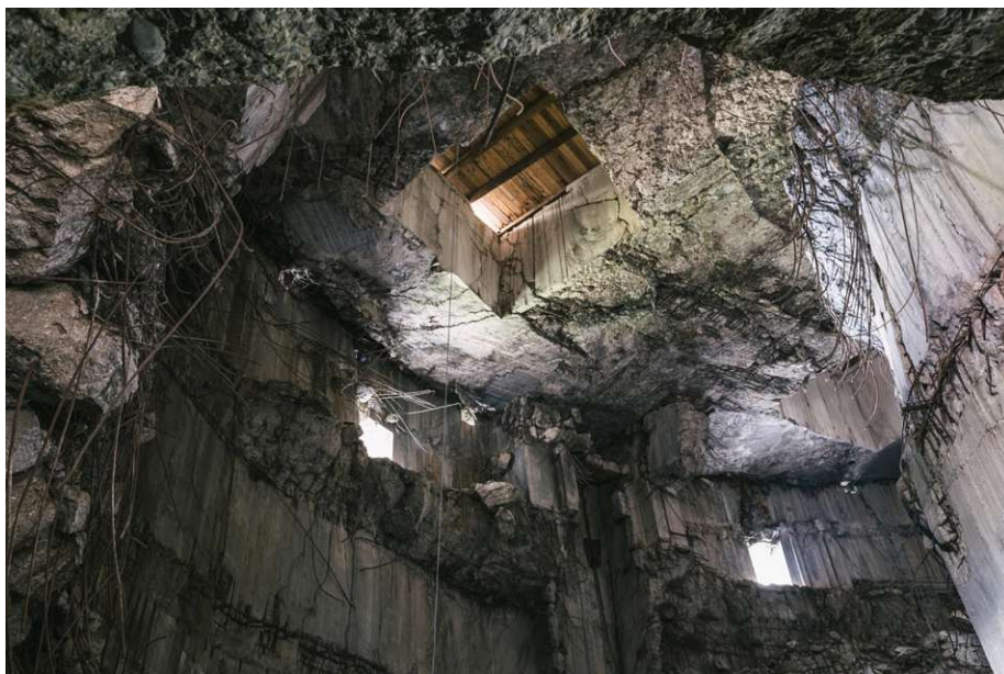
Abb 36 / Abb 37: Bauschäden im Inneren des Gefechtsturms Augarten (2016)
