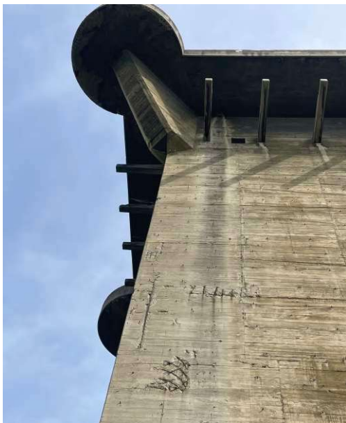
Abb 118: Einschussloch obere Plattform / Abb 119: Betonfassade mit Spiralbewehrung (2024)
