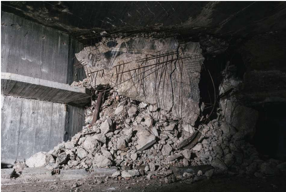
Abb 38 / Abb 39: Bauschäden im Inneren des Gefechtsturms Augarten (2016)
