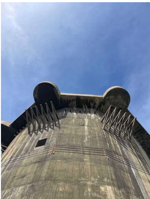
Abb 151: Beschädigte untere Plattform / Abb 152: Blick von unten auf den Gefechtsturm (2024)
