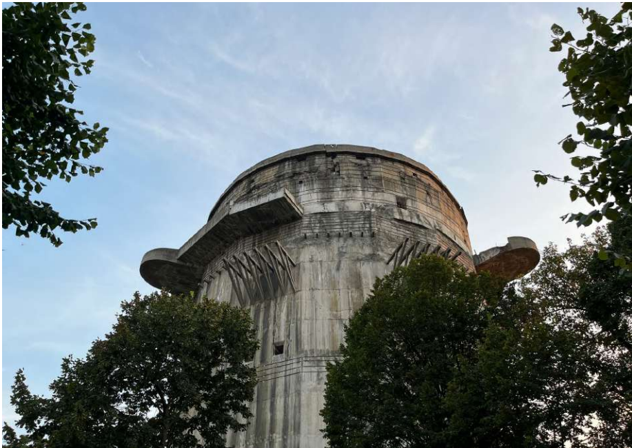
Abb 159/ Abb 160: Gefechtsturm mit Schäden an der unteren Plattform (2024)
