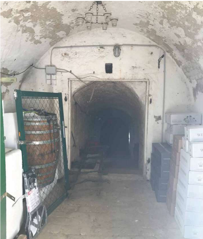
Abb.152 Vorhaus Weinkeller 2020, vor Sanierung
