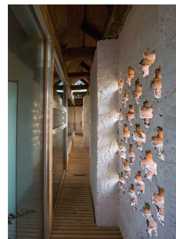
Abb. 141: Fuge zwischen neu und alt
