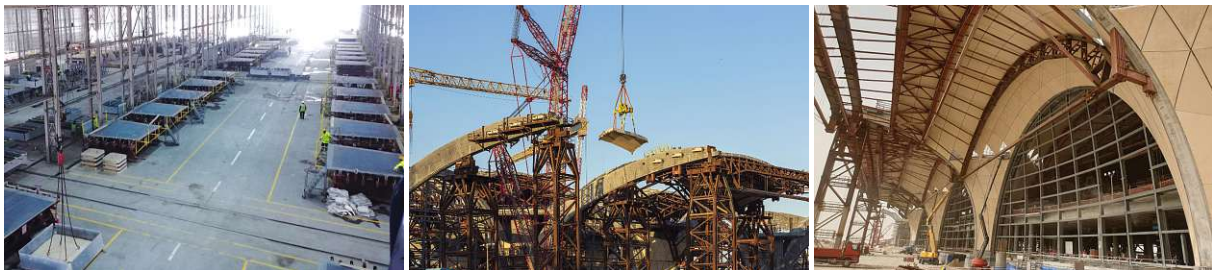
Abb. 2.11: Einsatz von ADAPA für die Herstellung der rund 40 000 Betonpaneele des Flughafens in Kuwait
