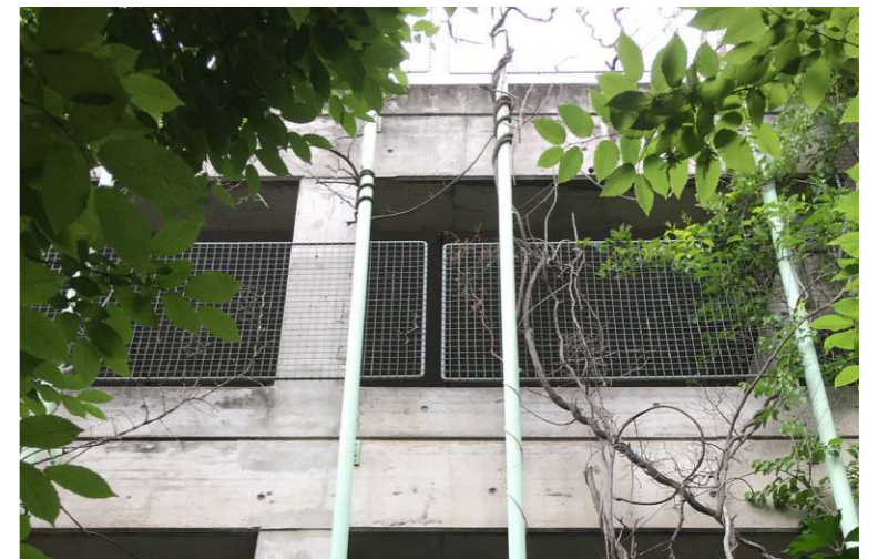
Abb. 28: Rankgerüst und Absturzsicherung
