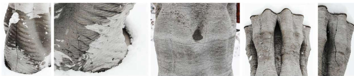
Abb. 5.8: Rissbildung durch Frost-Tau-Zyklen an Säulenbasis, Säulenschaft und Säulenkapitell (Quelle: Anton et al. [4], S. 12)
