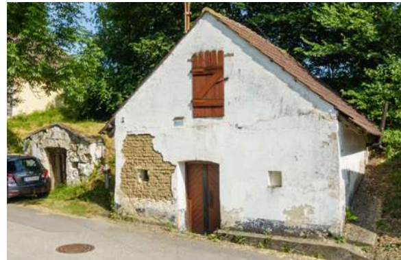
Abb. 4.9: Kleinschweinbarth, Kreuzberg . Notwendige Instandsetzung. Das Ergänzen des fehlenden Verputz und einem anschließenden Weißßen der Fassade wäre hier schon längst fällig. Der fehlende Putz führt besonders bei luftgetrockneten Lehmziegeln zu einem schnellen Erodieren und Substanzverlust des Mauerwerks.
