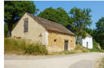
Abb. 3.29: Nodendorf, Gaisbüglweg Fehlender Putz an der Vorderseite und partielle Putzschäden an den Seiten.
