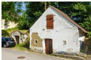
Abb. 3.2: Kleinschweinbarth, Kreuzberg Partielle Putzschäden und erforderlicher Neuanstrich (Weißnen).
