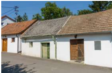
Abb. 3.16: Siebenhirten, Bahnkellergasse . Unpassende Dachdeckung mittels Faserzementschindeln.
