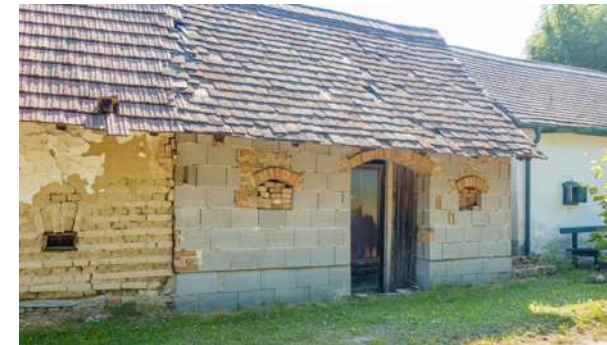
Abb. 4.171: Gebmanns, Südliches Ortsende . Betonsteine an der Fassadenfront sollten vermieden werden.
