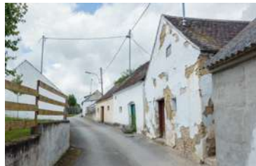
Abb. 3.22: Grafensulz, Hintaus . Dringend notwendige Putzsanierung. Beeinträchtigt Gesamteindruck durch Stromleitungen auf den Dächern.
