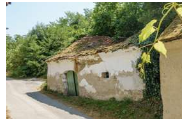
Abb. 3.49: Absdorf, Absberg Desolater Gesamteindruck. Statische Integrität kaum noch vorhanden. Tiefgreifende Sanierung unumgänglich.
