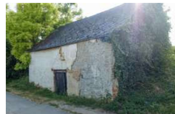
Abb. 3.3: Kleinschweinbarth, Hintaus Großflächige Putzschäden durch scheinbar falsches Putzmaterial (Zementputz?). Unpassende Dachdeckung (Faserzement).
