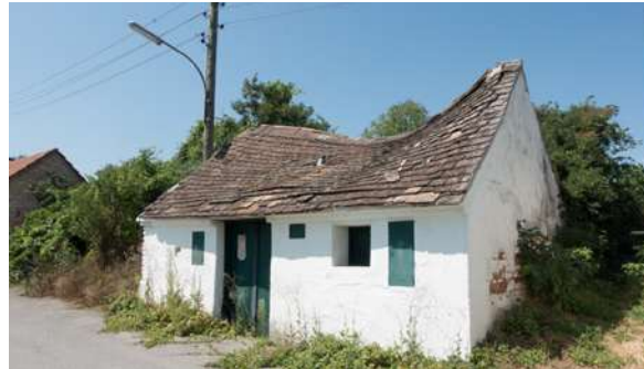
Abb. 4.10: Kleinhadersdorf, Schnellern Keller . Notwendige Sanierung. Bei diesem Presshaus weist das durchhängende Dach auf einen desolaten Dachstuhl hin, was meist auf einer undichten Dachdeckung beruht. Eine Sanierung ist unumgänglich. Ob der Dachstuhl repariert werden kann oder ein Austausch nötig ist, muss bei einer genaueren Begutachtung festgestellt werden.
