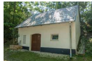
Abb. 3.39: Hausleiten, Lehrngasse Falsche Dacheindeckung mittels Faserzementschindeln sowie unangemessene Sockelausbildung.
