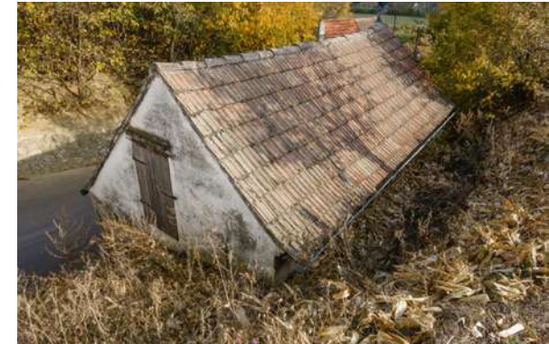
Abb. 4.200: Poysbrunn, Franzensberg . Eine schlecht gewartete Rinne hinter dem und seitlich vom Presshaus führt meist zu Feuchtigkeitsschäden am Mauerwerk. Das gelegentliche Säubern der Rinnen kann die Lebensdauer eines Presshauses erheblich verlängern.
