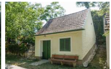
Abb. 3.40: Hausleiten, Lehrngasse Putz zu wellig ausgeführt und Fensteröffnung zu groß und außen bündig.
