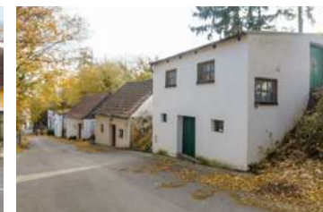
Abb. 3.7: Poysbrunn, Franzensberg Scheinbar nachträgliche Aufstockung eines Presshauses mit viel zu großen Fenstern und deplatziertem Pultdach.
