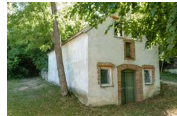
Abb. 3.34: Wollmannsberg, Hohlweg Falscher Einbau (außen bündig) von viel zu großen Kunststofffenster. Faschen um Tür und Fenster sind auch fehl am Platz.
