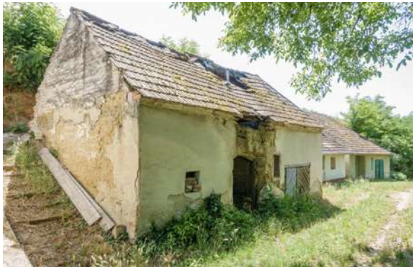
Abb. 4.8: Kirchberg, Mühlweg . Unterlassene Instandhaltung. Durch die beschädigte Dacheindeckung kam es zu einer Durchfeuchtung des Mauerwerks und einer daraus folgenden Substanzschädigung. Das gelegentliche Nachstecken der Dachziegel steht in keinem Verhältnis zu der nun nötigen tiefgreifenderen Sanierung.
