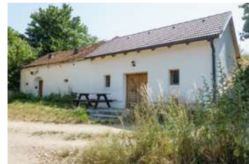
Abb. 3.33: Großrußbach, Sulzweg Im Vergleich zu einem gut erhaltenen alten Putz (links) sieht man die negative Wirkung eines zu glatten neuen Putz.
