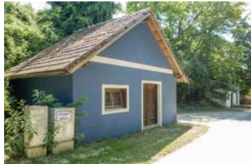
Abb. 3.41: Gaisruck, Zum Himmelreich Unangemessene Farbgebung und zu großes Fenster.
