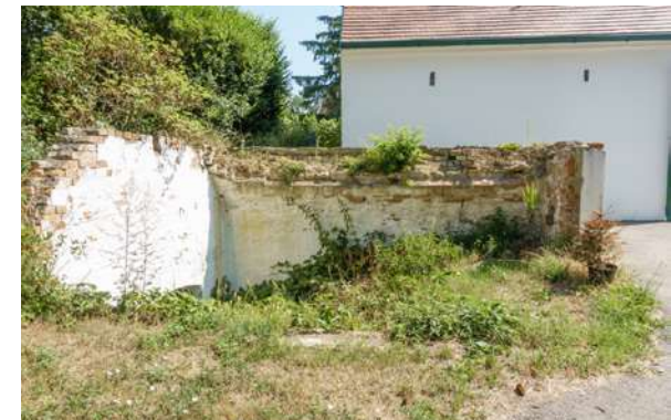
Abb. 4.14: Kleinschweinbarth, Grundern. Notwendige Konservierung. Durch eine Konservierung der noch vorhandenen Bausubstanz könnte man diese für einen späteren Wiederaufbau erhalten,
