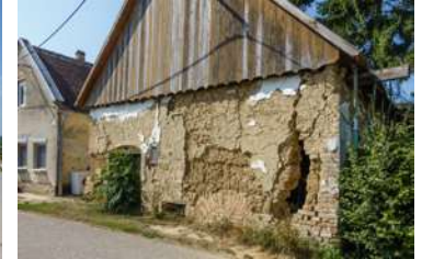
Abb. 3.15: Siebenhirten, Hintaus . Desolates Mauerwerk. Statische Gefährdung der gesamten Struktur.
