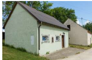
Abb. 3.23: Grafensulz, Hintaus . Unpassende Farbgestaltung und Fenstergitter. Falsche Dachdeckung aus Wellplatten.
