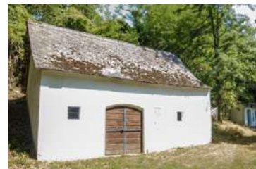
Abb. 3.38: Hausleiten, Lehrngasse Falsche Dacheindeckung mittels Faserzementschindeln.
