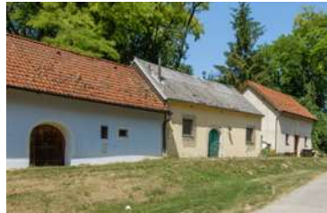
Abb. 3.42: Gaisruck, Zum Himmelreich Falsche Dacheindeckung mittels Wellplatten und unpassende Fenstergitter vor zu großen Fenstern.
