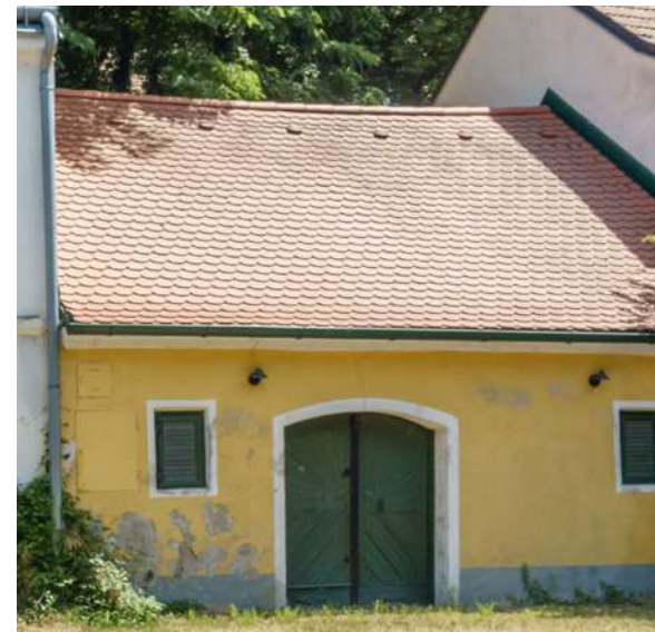
Abb. 4.194: Absdorf, Absberg. Die Ziegleindeckung in Biber-schwanzform zerstört die Authentizität eines Presshauses. Noch dazu in Verbindung mit der Rundumverblechung und einem un-passenden Fassadenanstrich.
