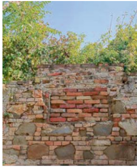
61 September 2024 Nahaufnahme der Wand. In der Ziegelwand ist eine vermutlich zugemauerte Fensteröffnung zu erkennen. Von hinten ist die Wand überwachsen von Gebüsch.
