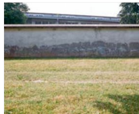
113 Juli 2023 Aufnahme aus der Gaßmannstraße auf die Mauer, die das Gelände abgrenzt.
