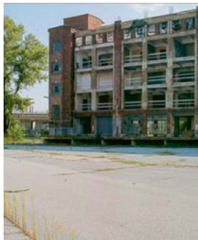
103 September 2024 Aufnahme der Fabrikanlage in der Ruthnergasse , letzter der wenigen Überreste der Fabrikanlage. Das mehrstöckige Gebäude ist notdürftig abgesichert – es scheint umgebaut zu werden.
