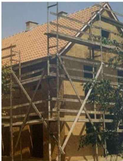
Abb. 4: Fassade ohne Verkleidung
