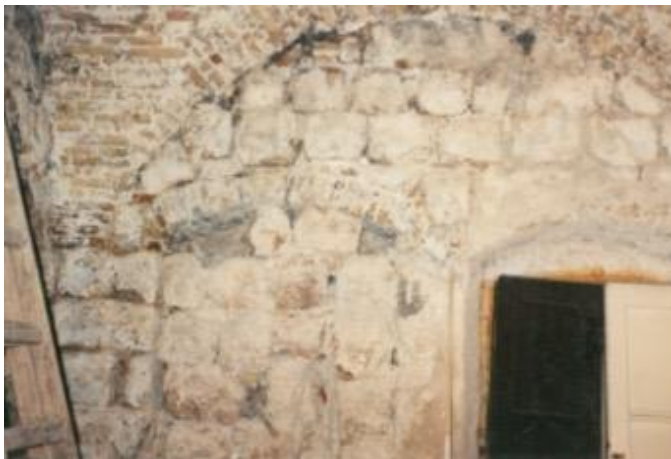
Abbildung 92: Sichtbare Spuren einer weiteren Öffnung in der Wand
