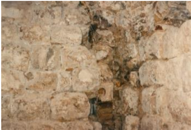
Abbildung 90: Risse in den Wänden
