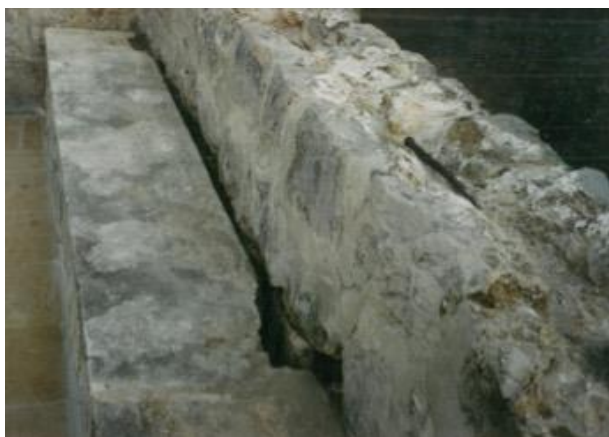
Abbildung 99: Mauerkrone und Sitzbank vor der Sanierung
