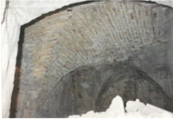
Abbildung 93: Abschalgen des Putzes von den Kreuzgewölben
