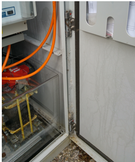
(d) Potenzieller Auslöser der Korrosion: Kondenswasser im unbeheizten Schrank
