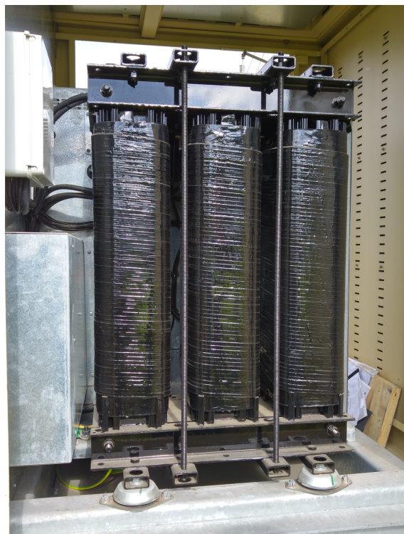
(b) Innenansicht, Koppeltransformator 3-phasig
