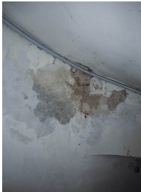
Abb. 180 Abplatzungen der Putzoberfläche im Erschließungsturm des Rothschild-Coudés
