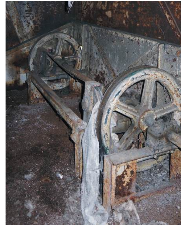
Abb. 143 Räderwerk auf der Galerie 2
