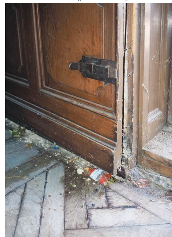
Abb. 199 Beschädigung der Wandverkleidung, Beobachtungsraum, Rothschild-Coudé
