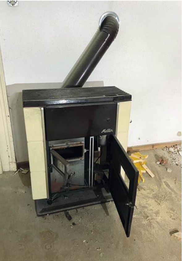
Abb. 368 Kaminauslass bei Tür, EG_08_T_01
