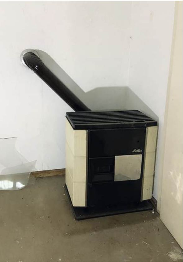
Abb. 361 Kaminauslass bei Tür EG_07_T_02
