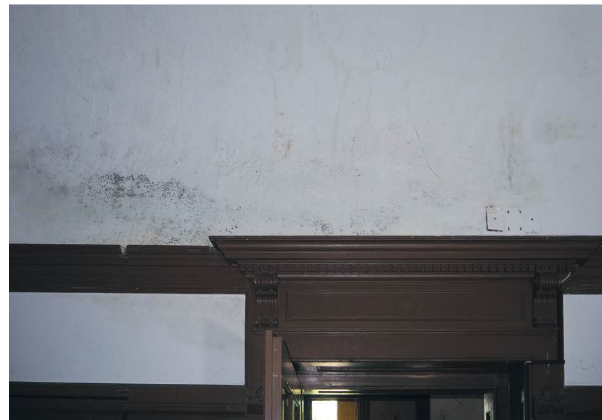
Abb. 198 Bläschenbildung und Verfärbung der Putzoberfläche, Aufenthaltsraum Rothschild-Coudé
