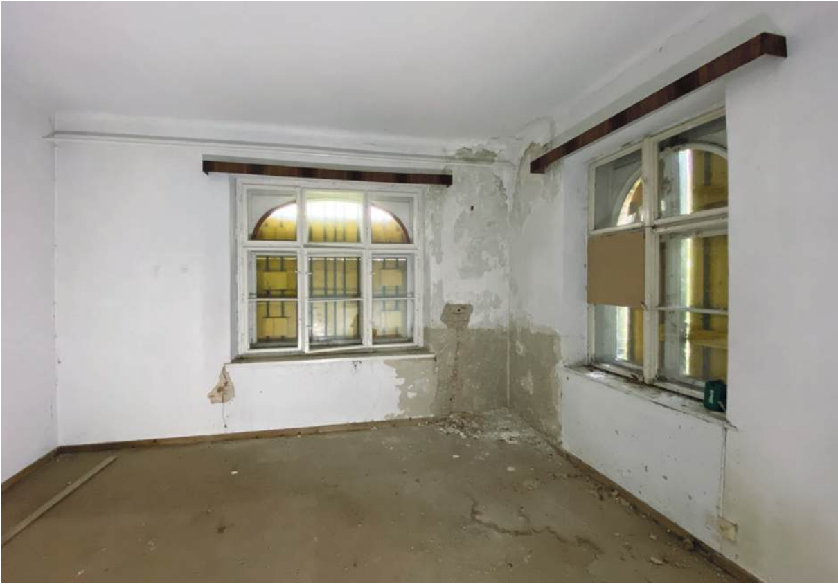
Abb. 358 Feuchtigkeitsschäden, nordöstliche Außenwanddecke
