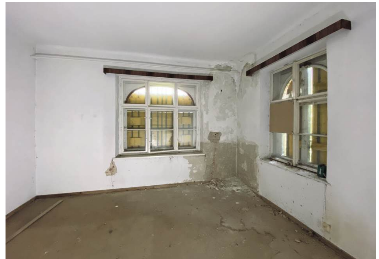
Abb. 203 Feuchtigkeitsschäden in der nordwestlichen Raumecke von Zimmer 1, Photographischer Pavillon
