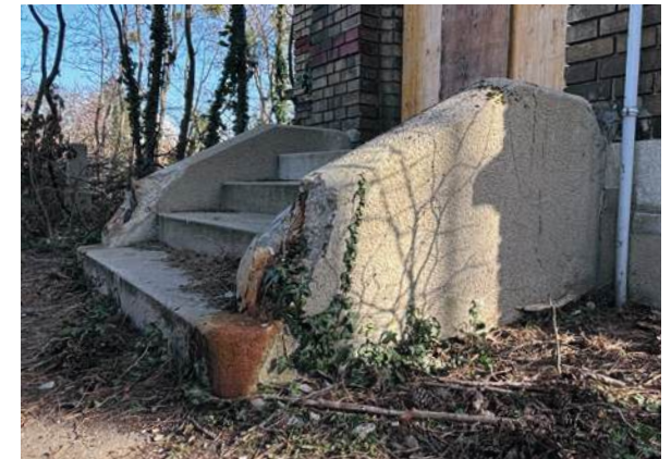
Abb. 183 Korrosionsschäden an der Außentreppe, Rothschild-Coudé
