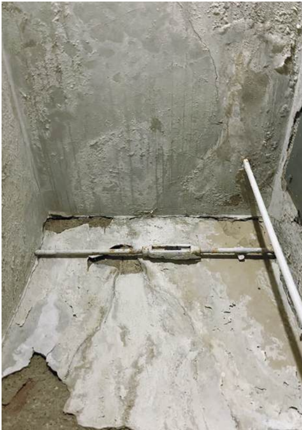
Abb. 393 Feuchtigkeitsschäden, westseitige Außenwand
