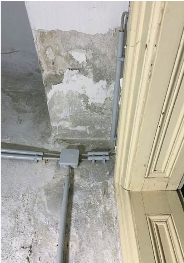
Abb. 396 Feuchtigkeitsschäden über Türsturz EG_14_T_01
