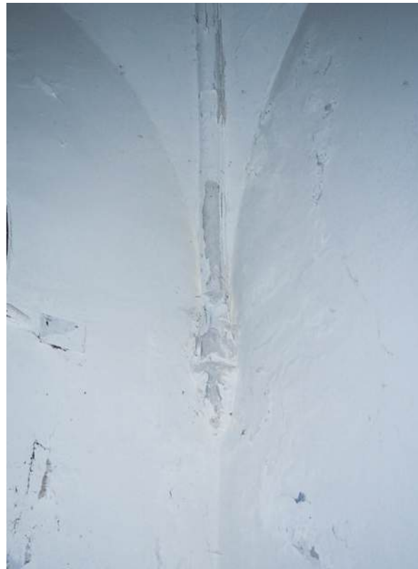
Abb. 179 Abplatzungen und Bläschenbildung der Putzoberfläche an der Kreuzrippe, im Foyer des Rothschild-Coudés
