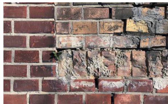
Abb. 188,189 abgeschlagener Fassadendekor, Photographischer Pavillon
