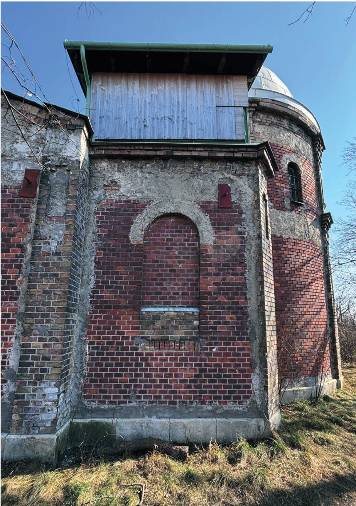
Abb. 151 Ansicht West, Bereich Verschnittfläche Stiegenaufgang, Photographischer Pavillon, 2024
