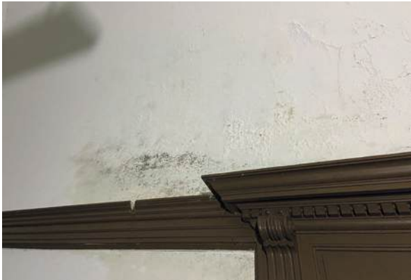
Abb. 288 Feuchtigkeitsschaden oberhalb Tür, EG_06_T_01
