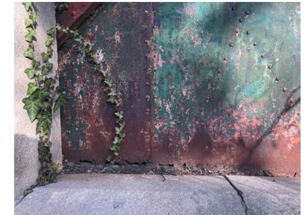
Abb. 195-196 Korrosionsschäden an der Oberfläche Schutzhülle, Rothschild-Coudé
