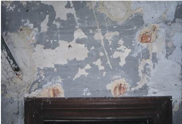
Abb. 297 Putzschäden, oberhalb der Tür, EG_06_T_02
