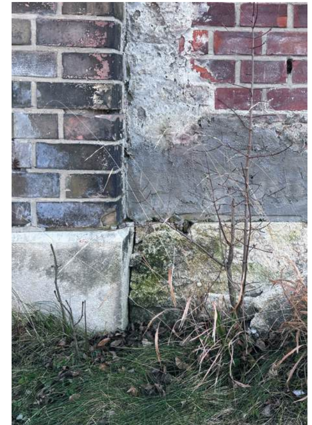
Abb. 191 Substanzverlust Sockel, Photographischer Pavillon
