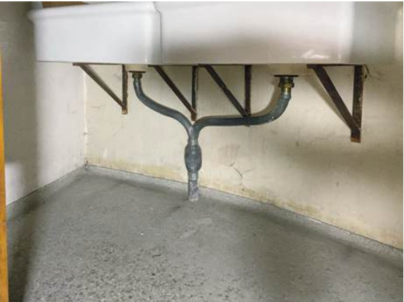
Abb. 386 Putzschäden unterhalb des Doppelwaschbeckens
