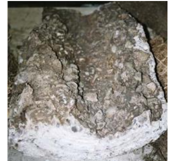
Verfestigte Ablagerungen (z.B. Betonrückstände)
