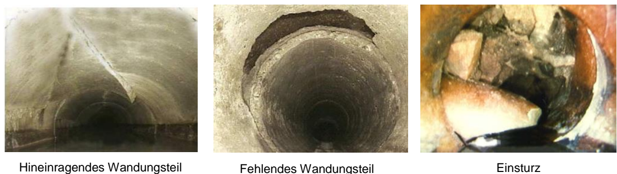
Abbildung 4.11: Bildbeispiele für Rohrbruch und Einsturz
