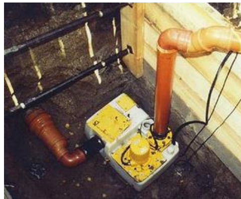
Abbildung 7.3: Fäkalienhebeanlage mit Sammelbehälter und Pumpe
