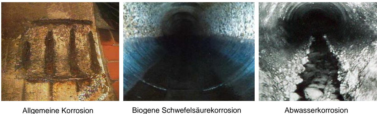
Abbildung 4.9: Bildbeispiele für Korrosionsschäden
