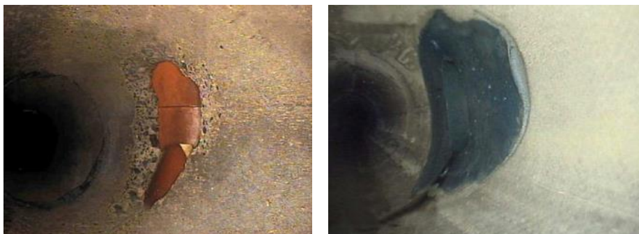
Unzulässig repariertes Loch (mit Ziegel)
