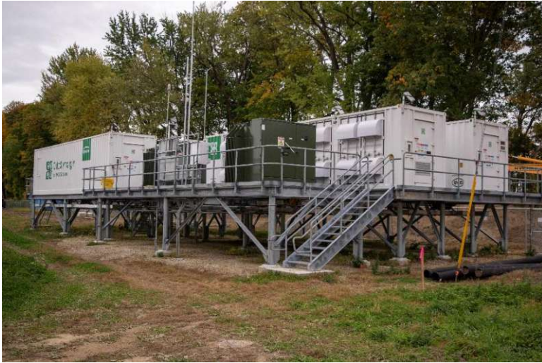
Abbildung 6: Die Energiespeicherkomponente des Projekts ist die größte Energiespeicheranlage in Massachusetts (Boston Society of Civil Engineers Section, 2022)
