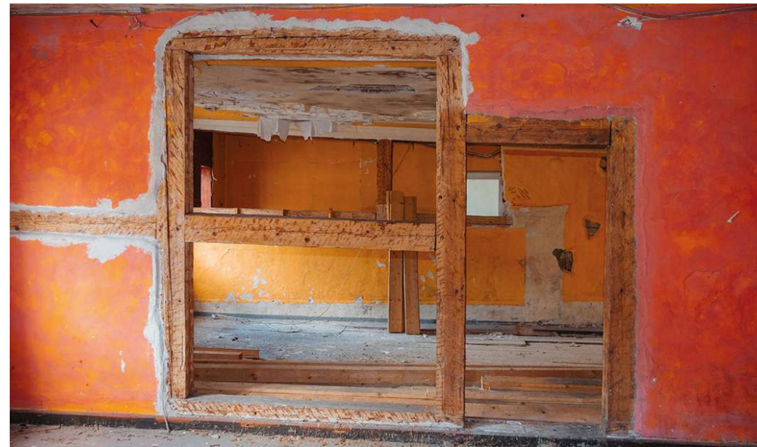
Abb. 56 Holzständerwand mit fehlenden Gefachen und ehemaliger Türöffnung
