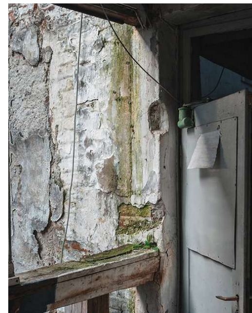
Abb. 84 Witterungseinfluss an der Südfassade des Hauptbaus
