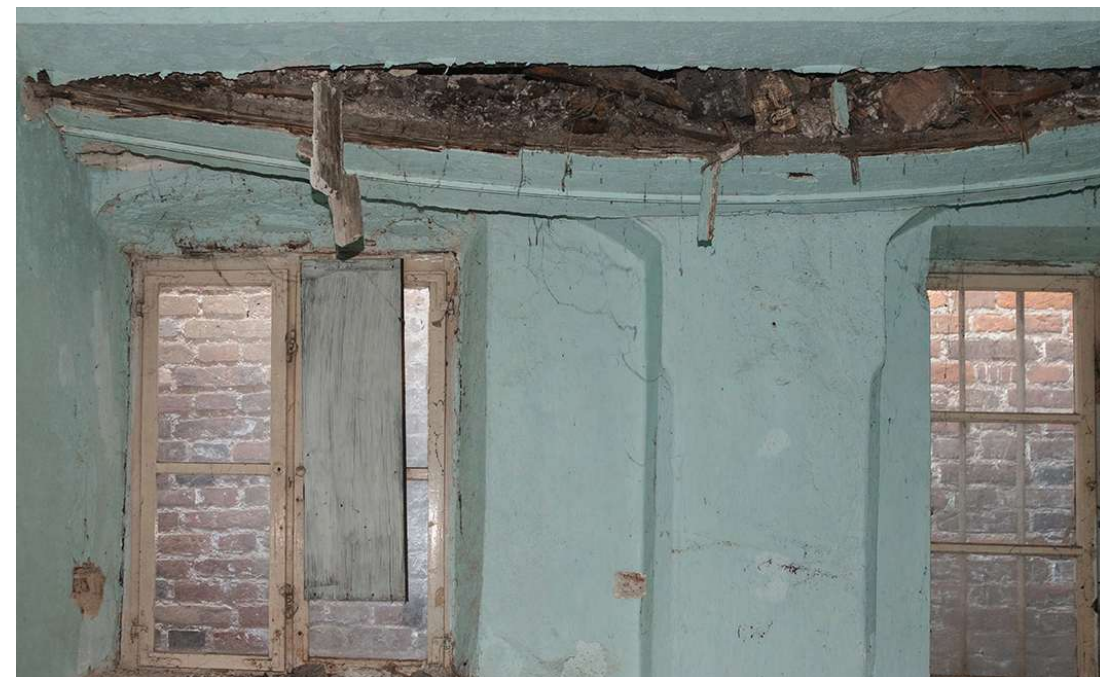
Abb. 87 Feuchtigkeitsschäden und Überlastungen im Deckenbereich
