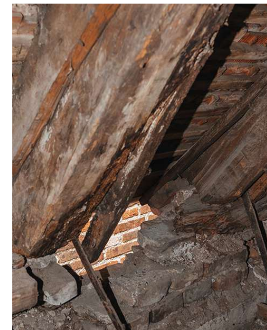
Abb. 85 Ausbrüche im Kniestockbereich
