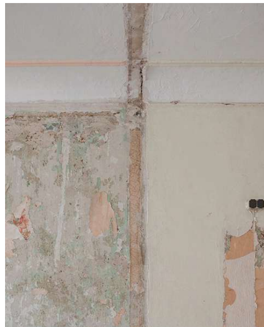
Abb. 141 Stuckdecken, Putzablösungen und Umbauten
