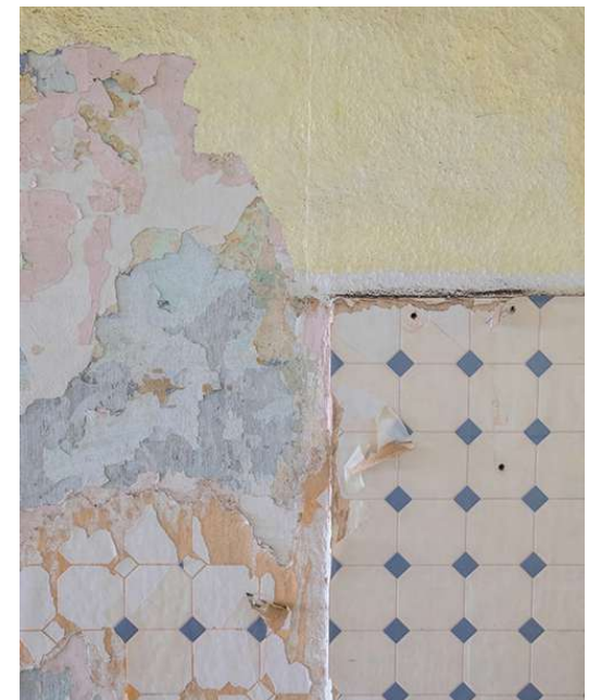
Abb. 143 Putzablösungen und überlagernde Zeitschichten
