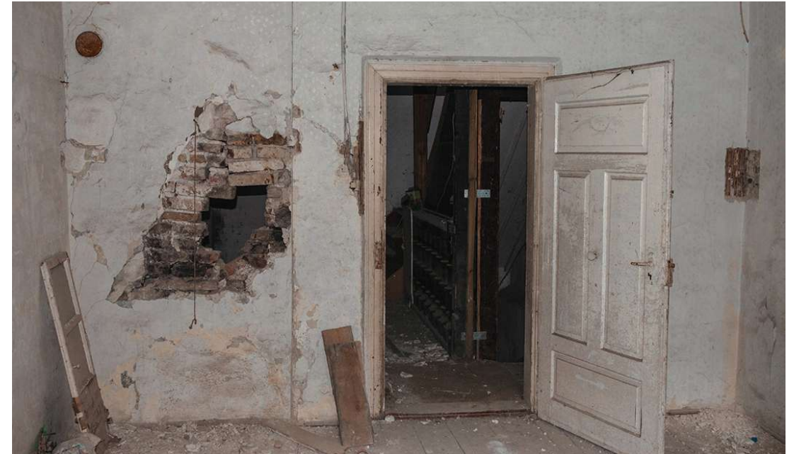
Abb. 89 Ausbrüche in den Wänden und hoher Verschmutzungsgrad
