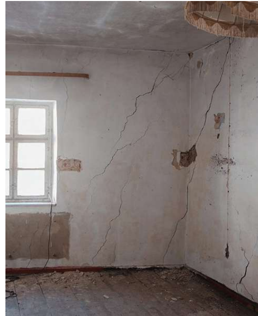
Abb. 88 Risse in den Wänden (hier im Rückgebäude)
