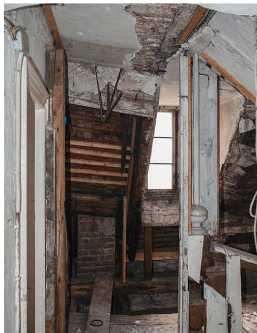
Abb. 55 Mansarde mit fehlender Bretterschalung
