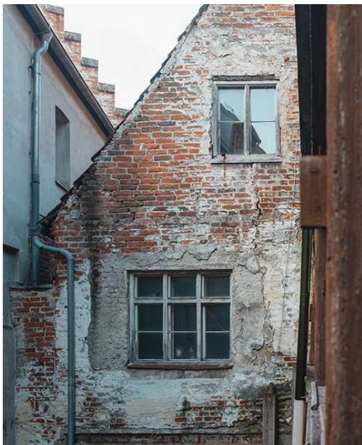
Abb. 137 Giebelwand der Hoffassade mit Altersspuren, wie verwittertes Mauerwerk und geglätteter Fugenmörtel
