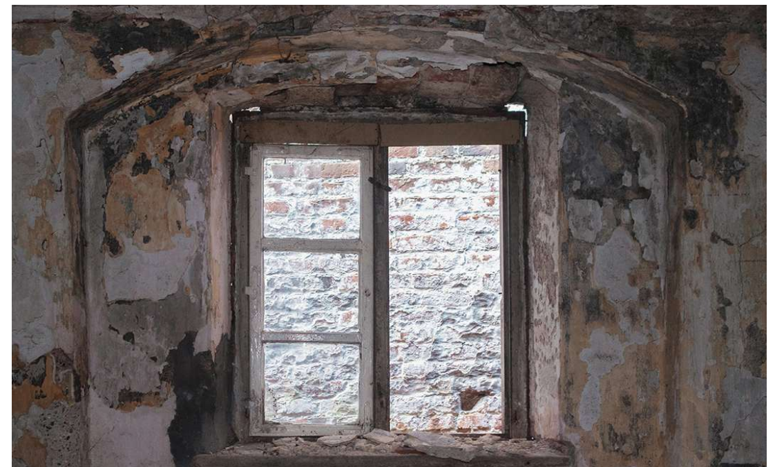
Abb. 90 Feuchtigkeitsspuren an den Wänden, abgeblätterter Putz und undichte Fenster
