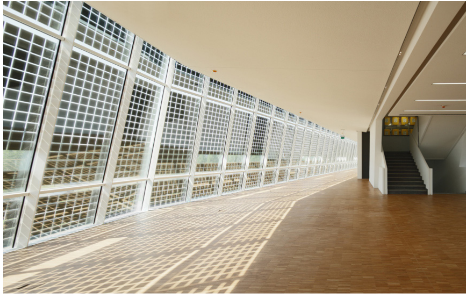
Abb. 7.3: Einsatz von semitransparenten Photovoltaik-Modulen
