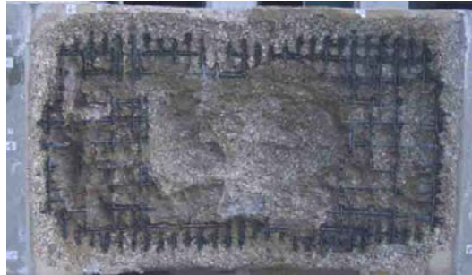
Abbildung 3.1: Tunnelinnenschale nach einer Brandbeanspruchung [30]
