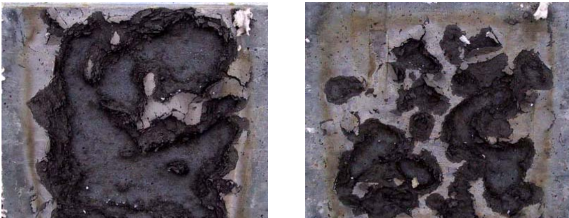
Abbildung 3.9: Abgeplatzte Betonbauteile von UHPC mit unterschiedlichen Stahlfasergehalten: links 200 \text{ kg/m}^3 Stahlfasern, rechts 300 \text{ kg/m}^3 Stahlfasern [2]
