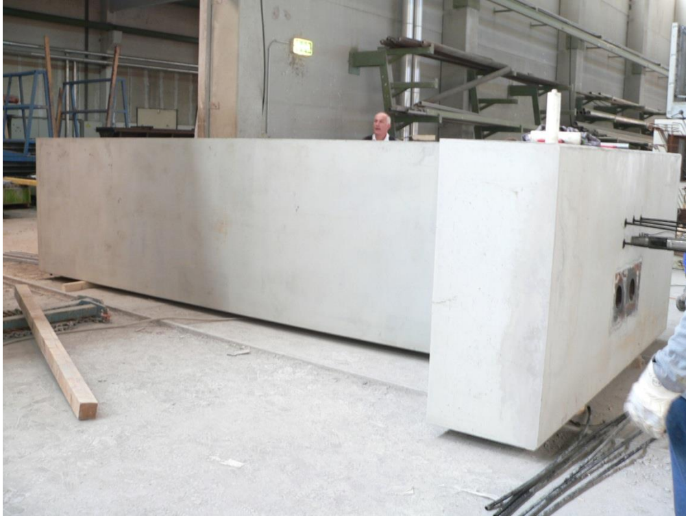
Abbildung III-78: Probelastung der Querträger zur Verankerung von 6 Monolitzen in einem trogförmigen Fertigteilträger aus Elementdecken
