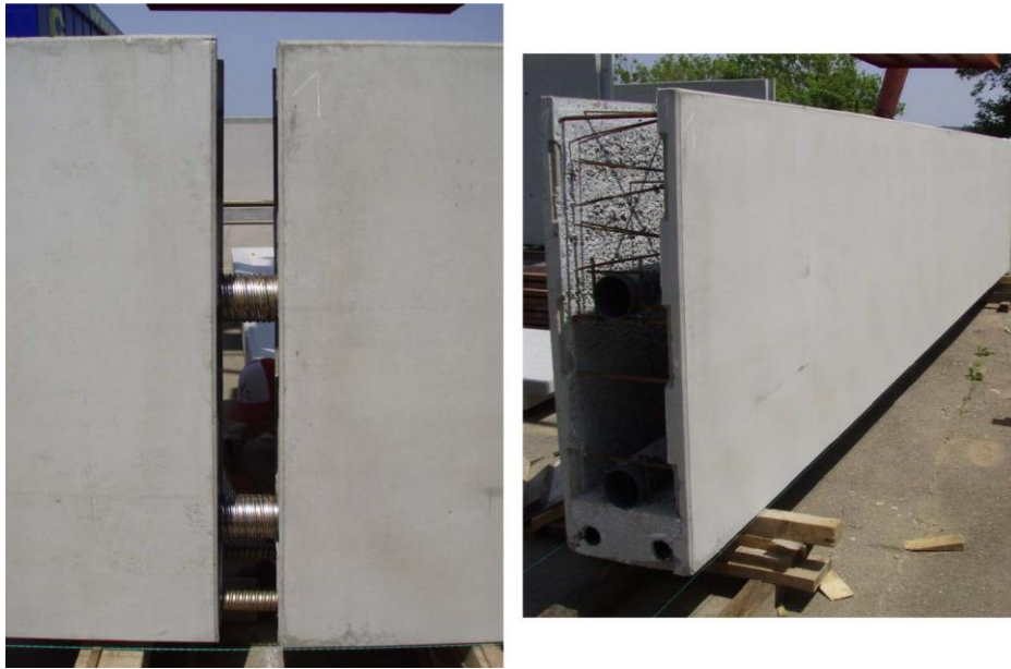
Abbildung II-43: Zusammensetzen der Elemente – links: Einschieben der Elemente – rechts: Einrichten des ersten Elements
