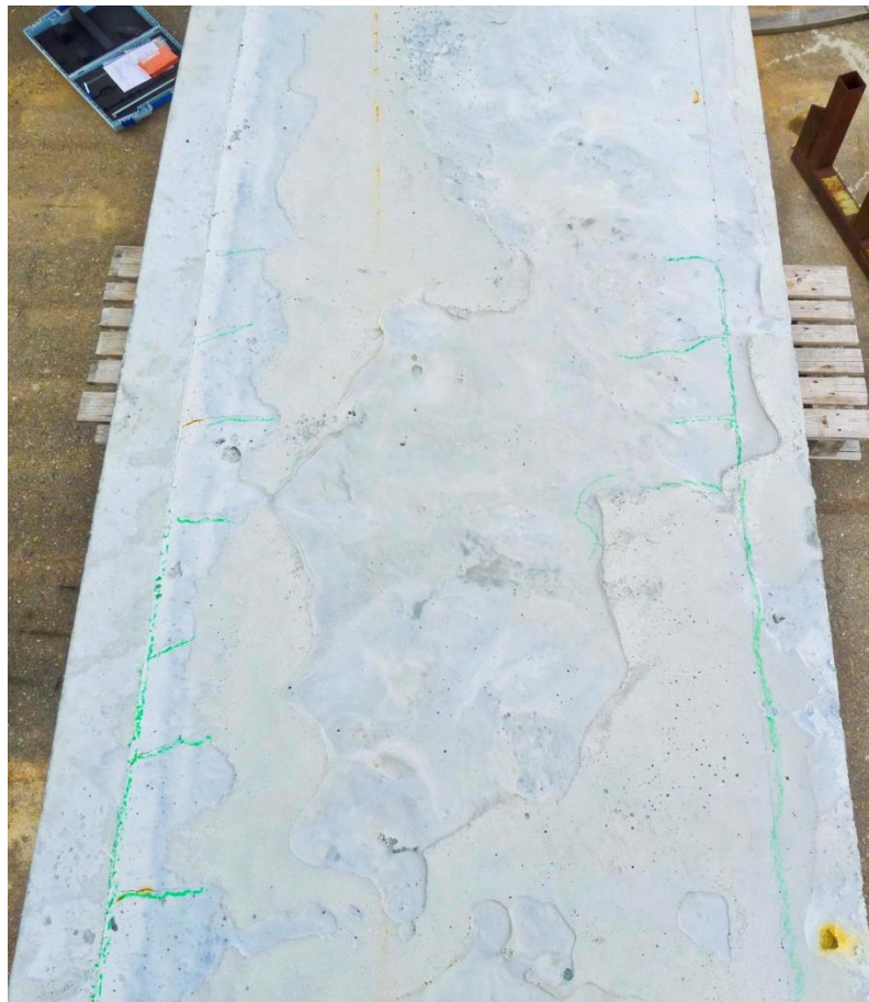
Abbildung III-52: Risse in der Oberseite des Versuchsträgers - Laststufe 903 kNm
