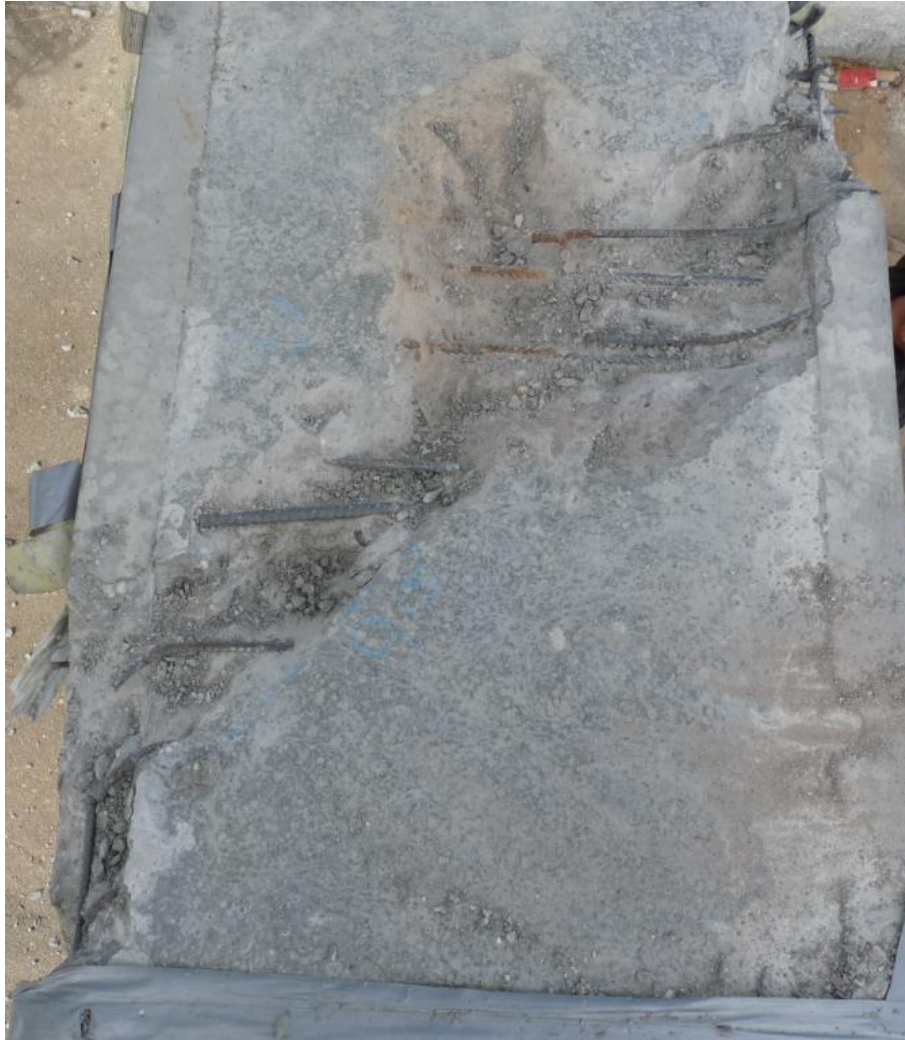
Abbildung III-71: Freigelegte Bewehrung im Bereich des Bruches
