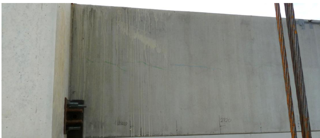
Abbildung III-64: Risse in der Hinterseite der rechten Versuchsträgerhälfte - Laststufe 1.075 kNm nach 115 Minuten
