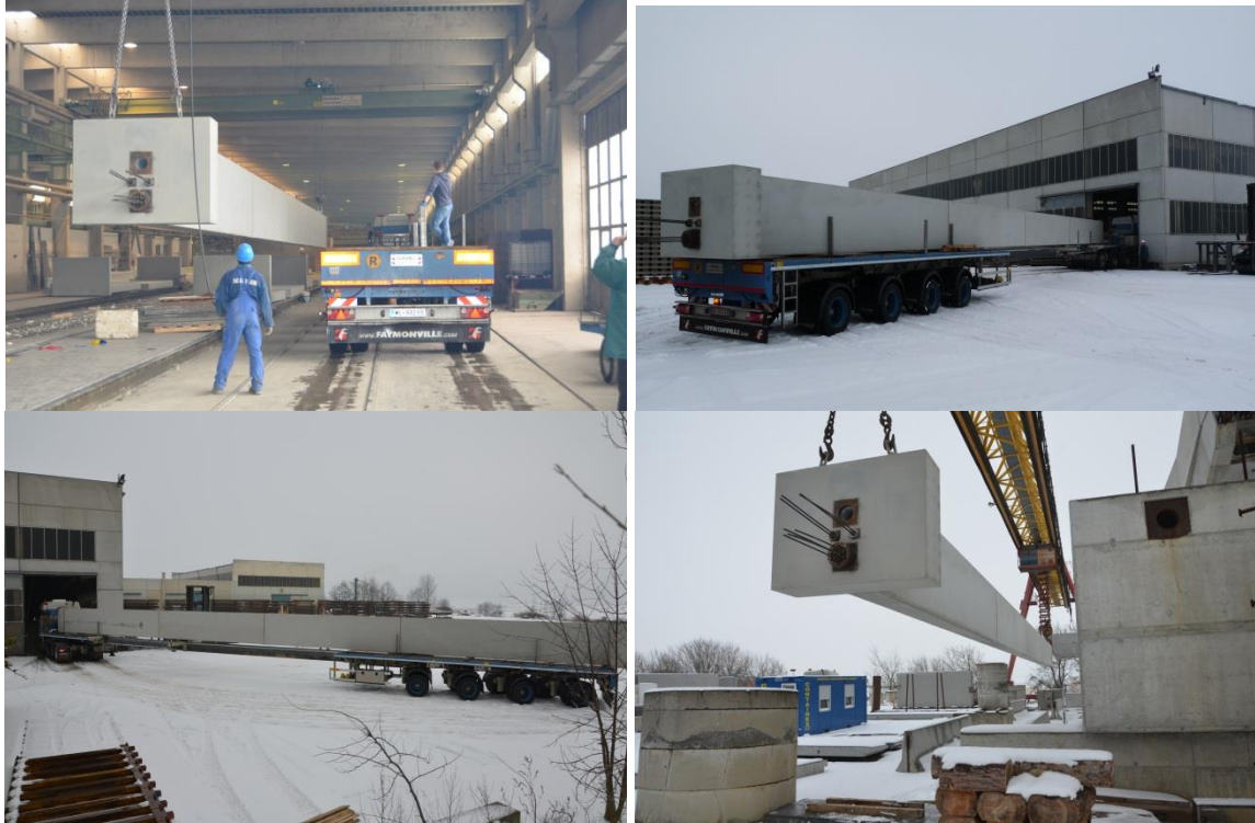
Abbildung II-52: Verladen des 30 m langen Fertigteilträgers und Einheben des Trägers auf dem Versuchsgelände
