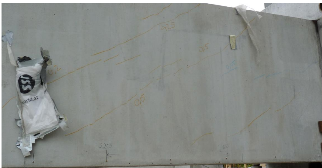
Abbildung III-66: Risse in der Hinterseite der linken Versuchsträgerhälfte - Laststufe 1.290 kNm
