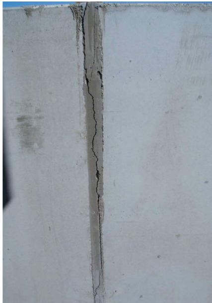
Abbildung II-46: Riss in der Vergussfuge durch Temperatureinwirkung
