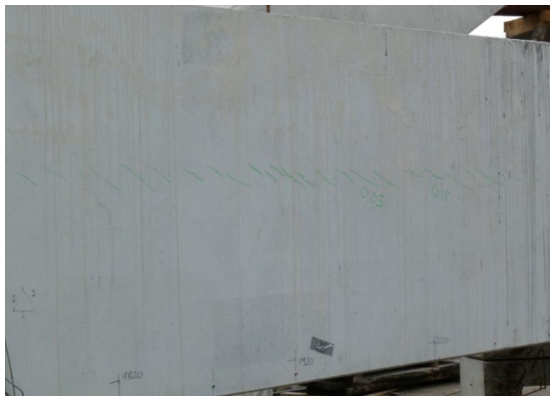
Abbildung III-63: Risse in der Vorderseite der rechten Versuchsträgerhälfte - Laststufe 1.075 kNm nach 115 Minuten
