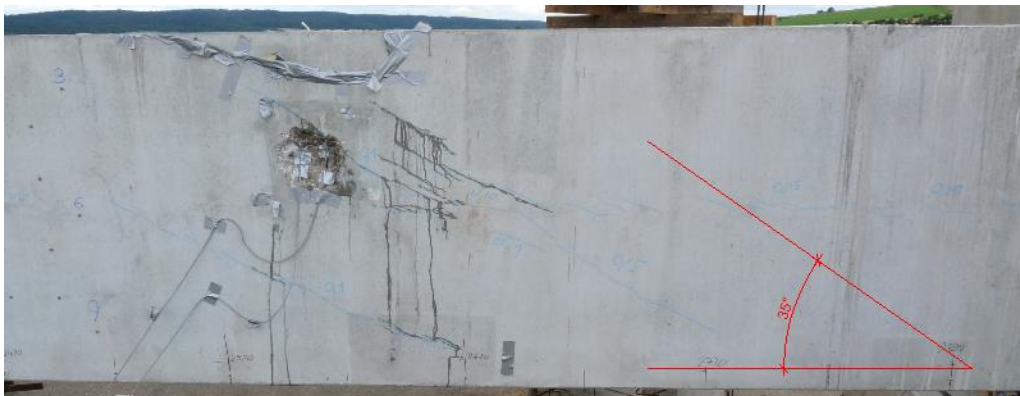
Abbildung III-57: Risse in der Vorderseite der rechten Versuchsträgerhälfte - Laststufe 1.075 kNm
