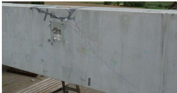
Abbildung III-68: Risse in der Vorderseite der rechten Versuchsträgerhälfte - Laststufe 1.290 kNm
