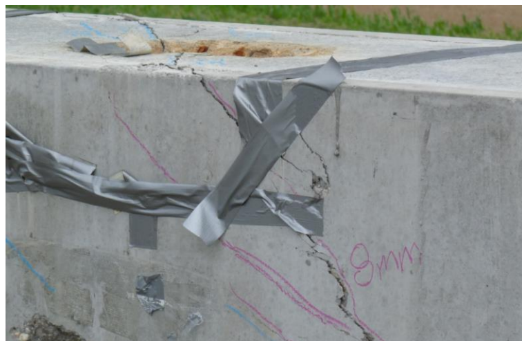
Abbildung III-69: Versagensstelle in der rechten Versuchsträgerhälfte
