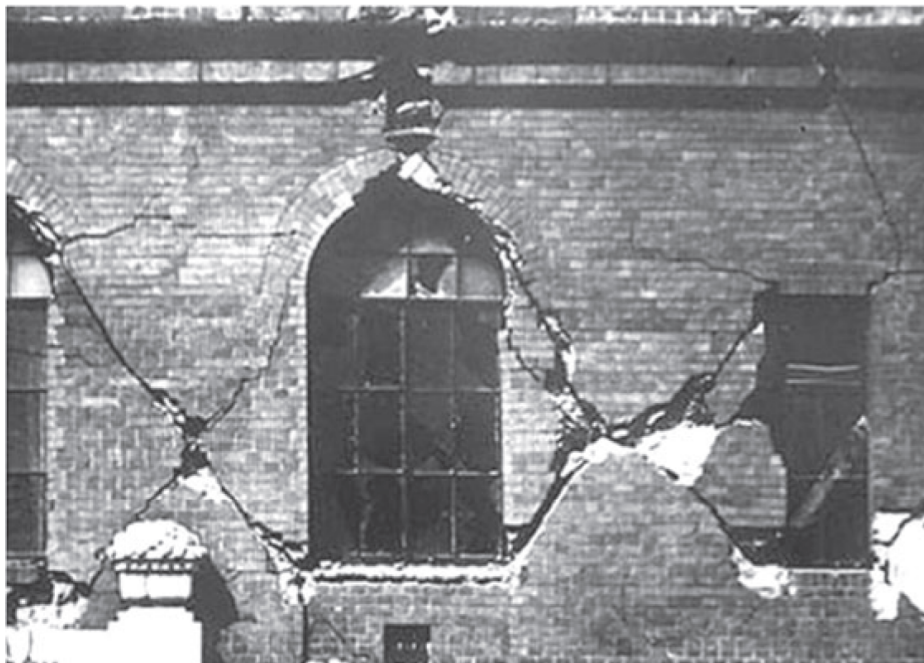
Abbildung 24: Scheibentragwirkung von Mauerwerkswänden, Schadensbild Kreuzrisse an einem realen Gebäude (aus [MESKOURIS11])
