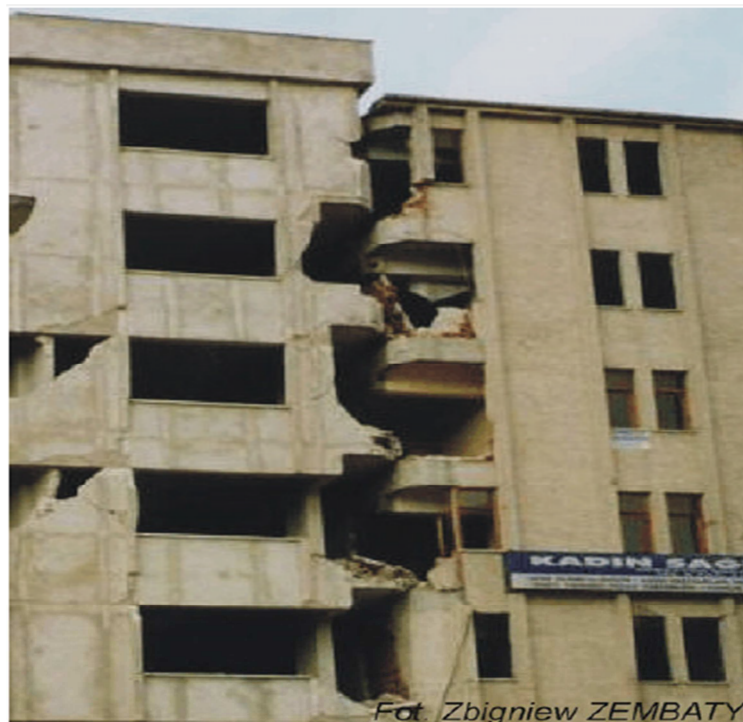
Abbildung 8: Zusammenstoß zweier Wohnhäuser während dem Izmit Erdbeben (Türkei 1999) [10]
