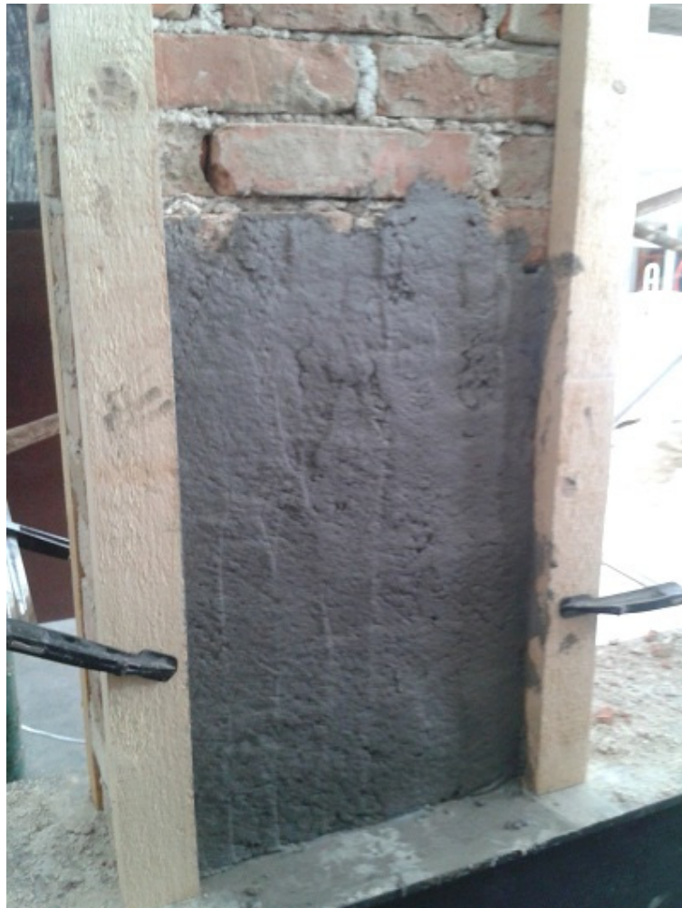
Abbildung 61 – SHCC Schicht auf Mauerwerkspfeiler, Prantl 2014
