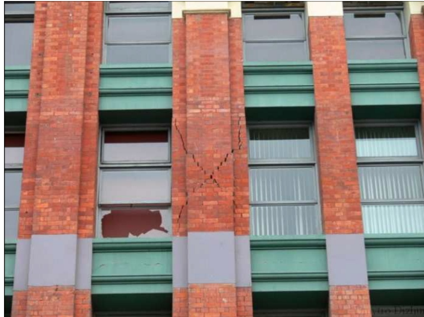
Abbildung 14 - Schaden an einem Pfeiler, Darfield Erdbeben 2010, Retrofitsolutions[25], [26]
