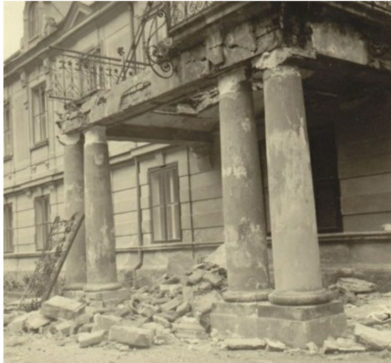
Abbildung 6 - Schaden an einem Gebäude in Seebenstein 1972, Quelle: ZAMG
