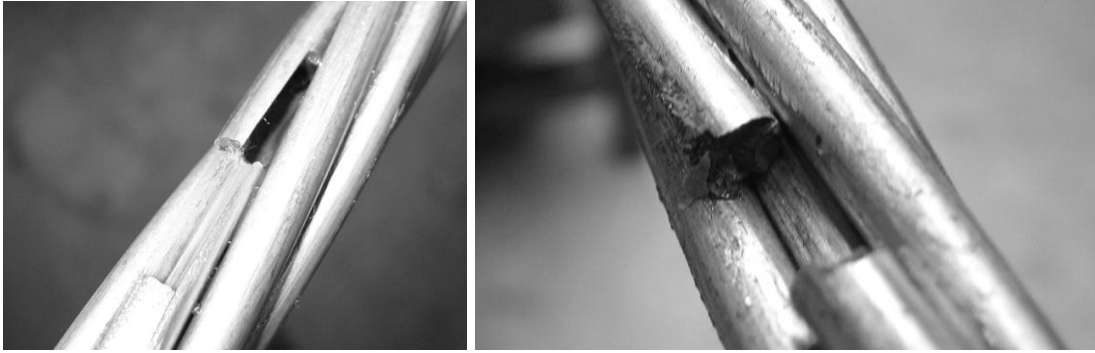
Abb. 63: Ermüdungsbrüche in der freien Länge (1)
