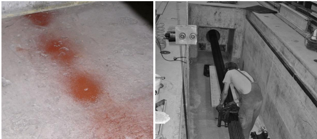
Abb. 69: Brauner Oxidstaub unterhalb des Prüfkabels (li); Anbringen des Zugrings (re)
