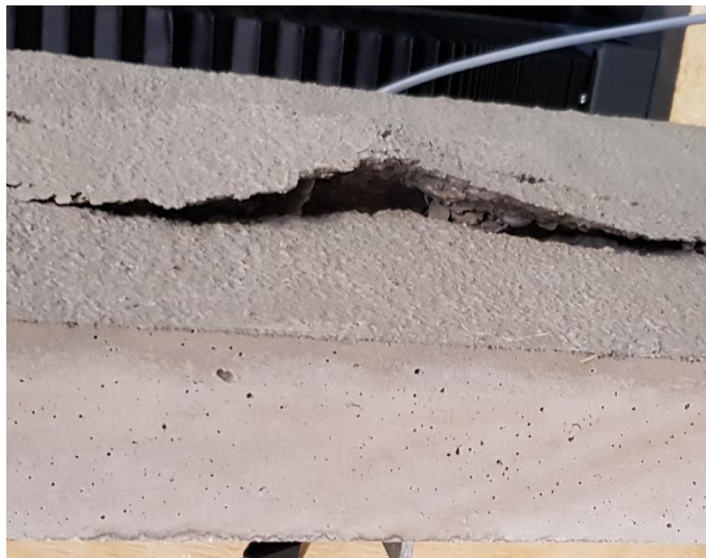
Abb. 62: Fehlen von Stahlfasern im Bereich der Betonabplatzungen
