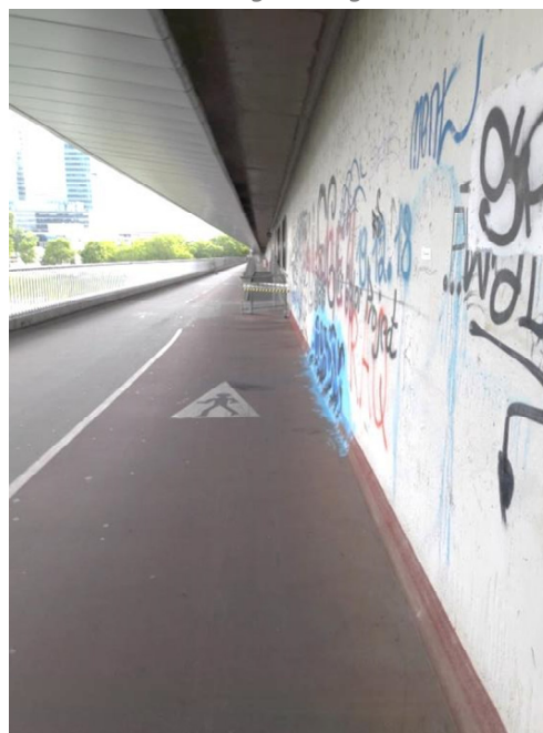
Abb. 75: Zweirichtungsradweg mit Hindernis
