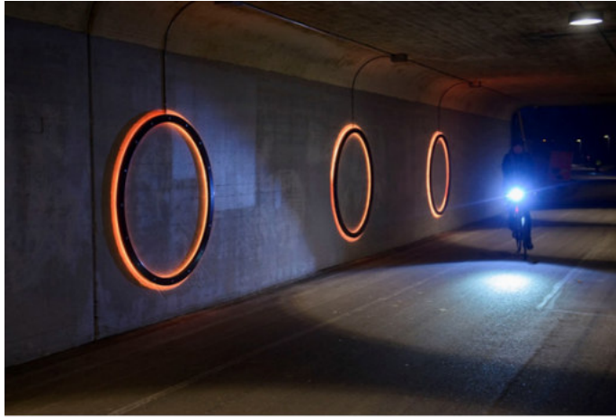
Abb. 33: Tunnelbeleuchtung in Dänemark
