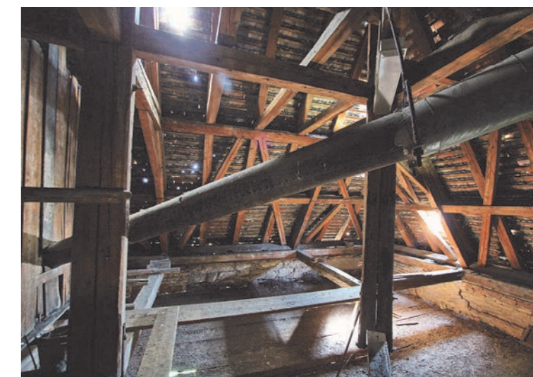
Abbildung 85 Dachgeschoß, Fragment der ehemaligen Entlüftung, südwestliche Ecke neben dem großen Saal eigene Aufnahme, April 2015
