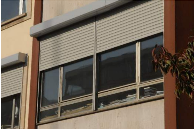
Abb. 54 Detail, Fenster mit nachträglich montierten Rollläden (2014)
