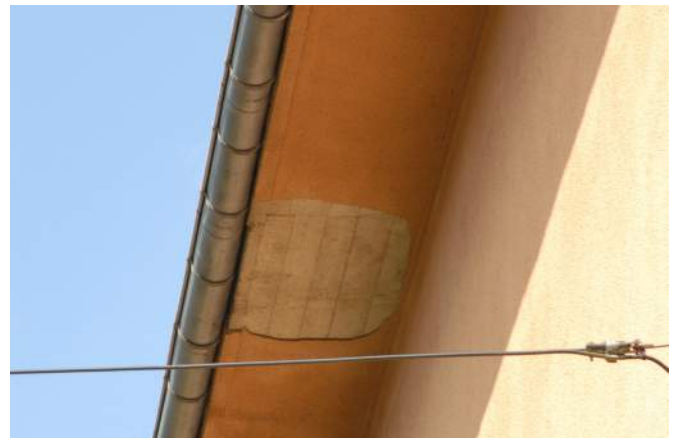
Abb. 50 Abplatzung des Putzes an der Dachunterseite (2014)
