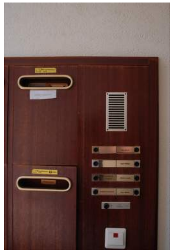
Abb. 248 Briefkästen und Klingelanlage im Appartementhaus Mailliet
