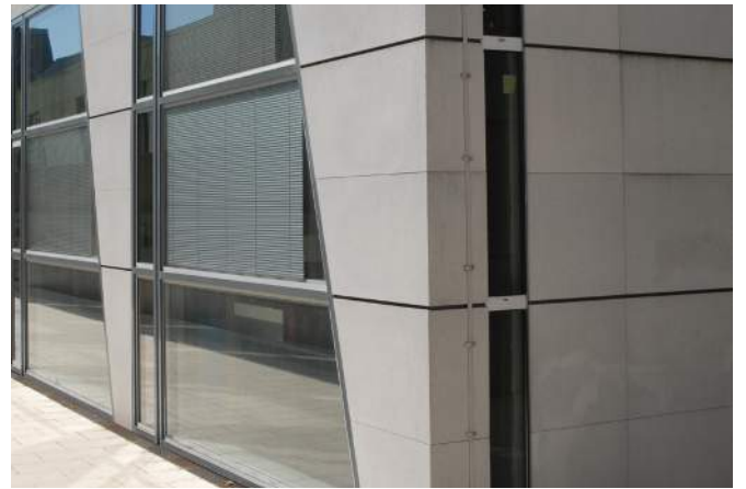
Abb. 177 Fugenbild nach Fassadenrenovierung (2015)
