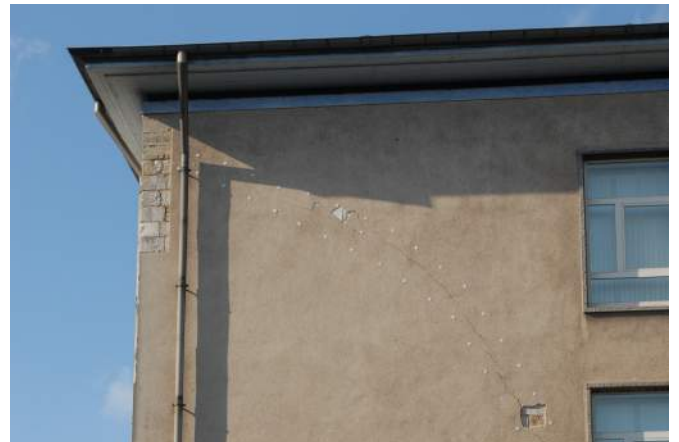
Abb. 157 Risse und Abbröckelungen am Fassadenputz (2014)
