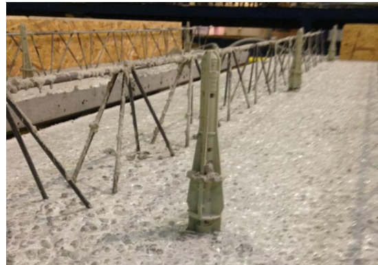
Abb. 5.20: Einbetonierte Kunststoffabstandhalter [HÜB16]
