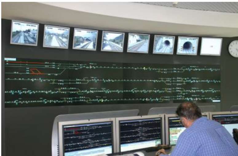
Abbildung 3-7: Leitzentrale der Vinschgaubahn am Bahnhof Meran. Quelle: STA.
