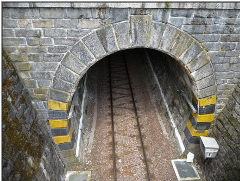
Abbildung 3-4: Y-Stahlschwellen am Tunnelportal des Josefsbergtunnels.
