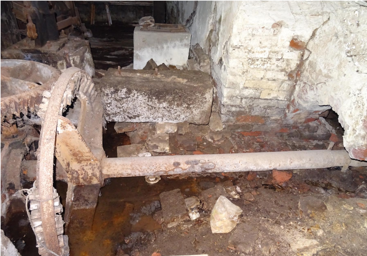
Abb. 123: Grundwasser im Antriebsraum
