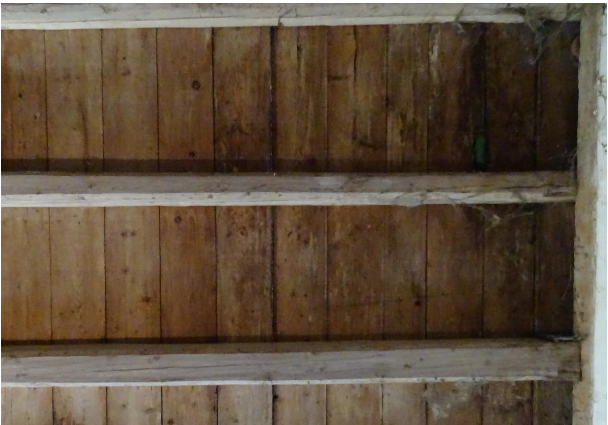
Abb. 134: Verfaulte Holzdielen in der Decke des Raumes 1.3
