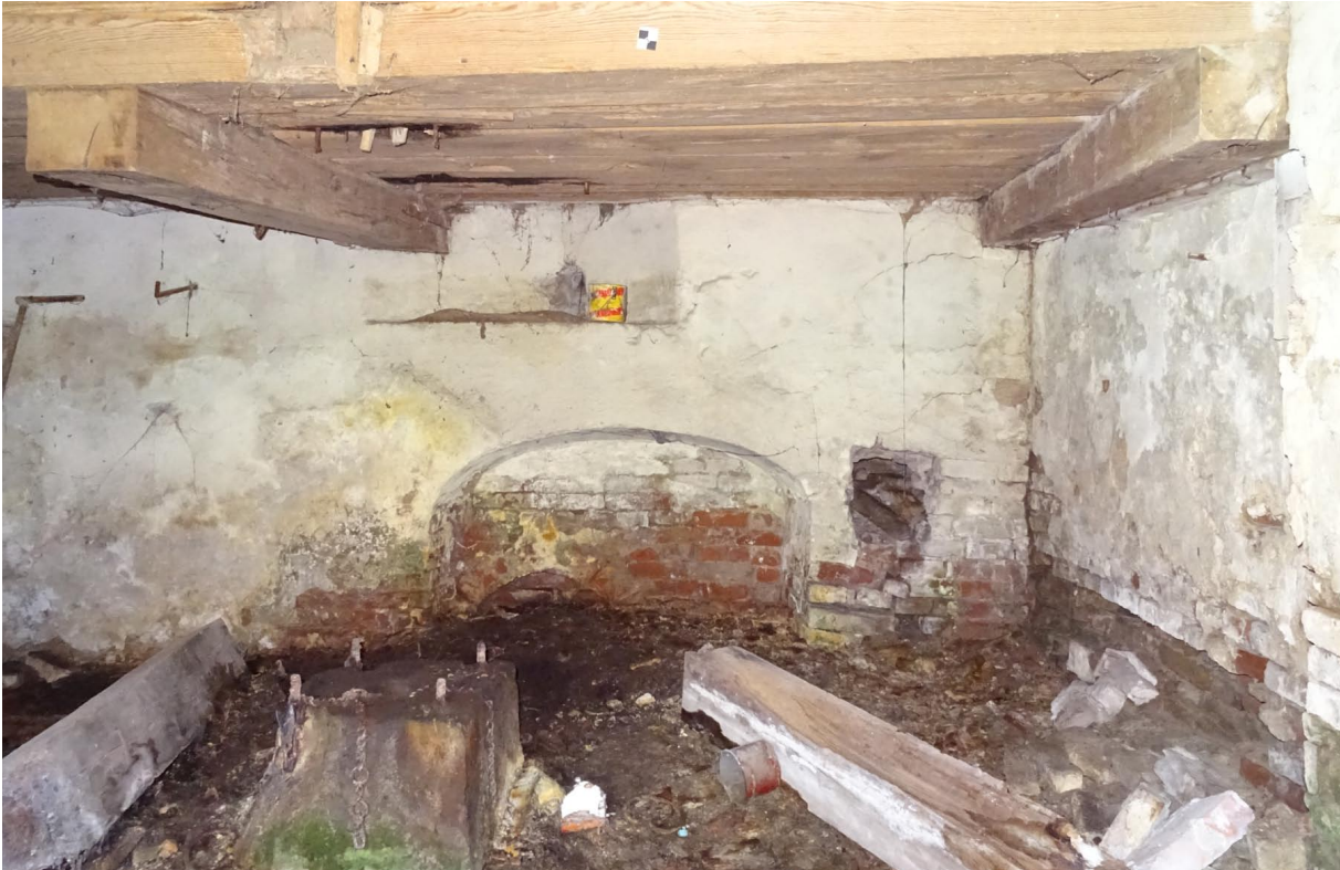
Abb. 119: Setzungen in der Mittelwand im Untergeschoß
