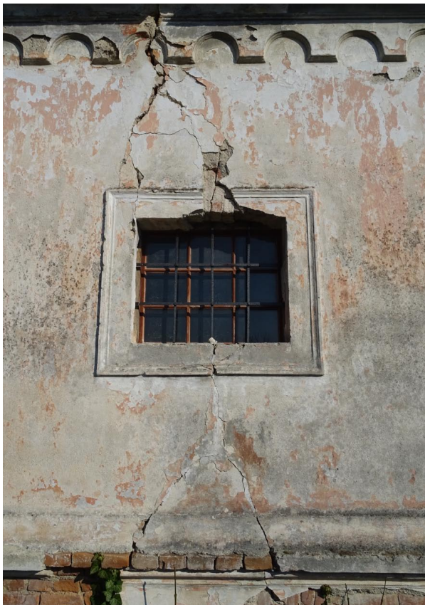
Abb. 126: Risse an der Westfassade bei Fenster 1F.12
