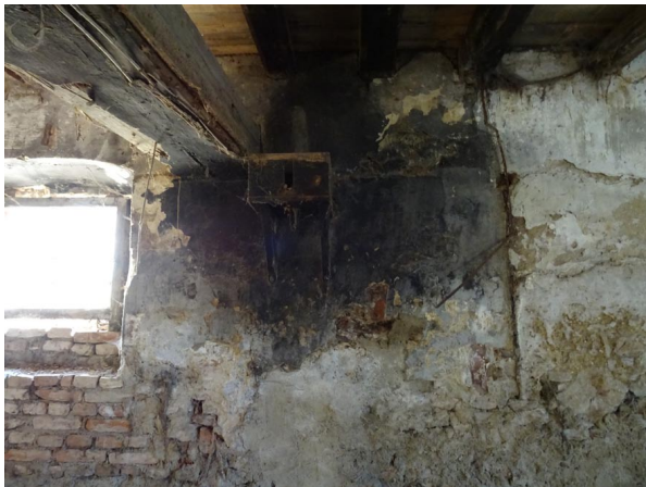
Abb. 267: Rußspuren in der Nähe des Sockels
