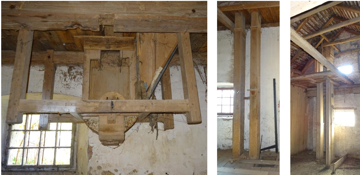
Abb. 180-182: Becherelevator Nr. 1 vom Antriebsboden bis zum Reinigungsboden
