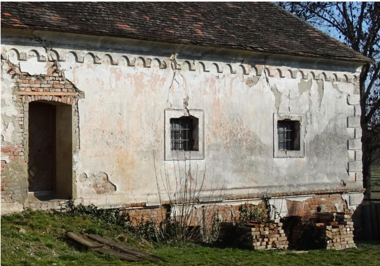
Abb. 120: Setzungen am südwestlichem Eck der Mühle
