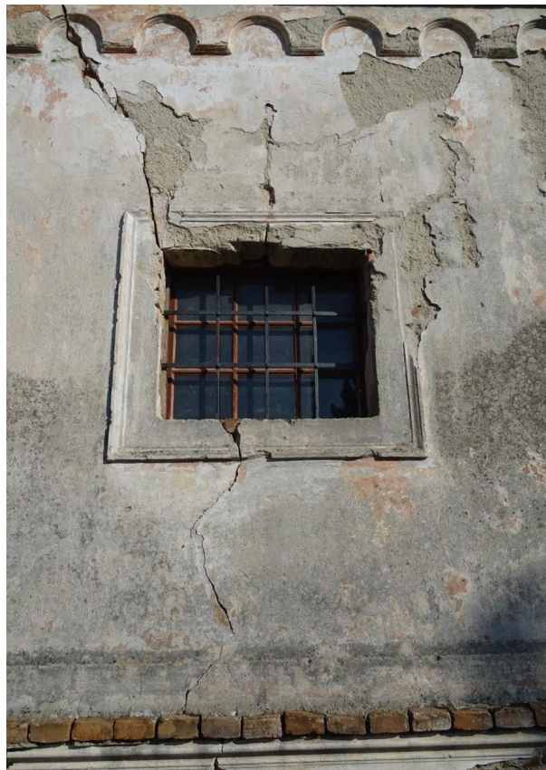
Abb. 127: Risse an der Westfassade bei Fenster 1F.11
