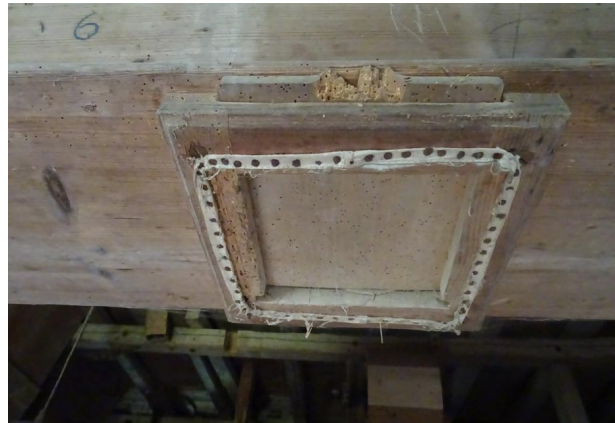
Abb. 255: Kontrollierbare Auslassöffnung, Sichter Nr.2
