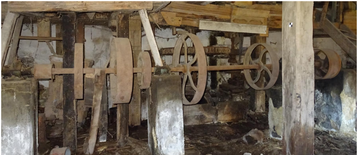
Abb. 170: Haupttransmissionswelle im Antriebsboden
