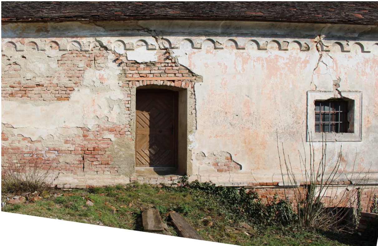
Abb. 125: Setzungsrisse an der Westfassade
