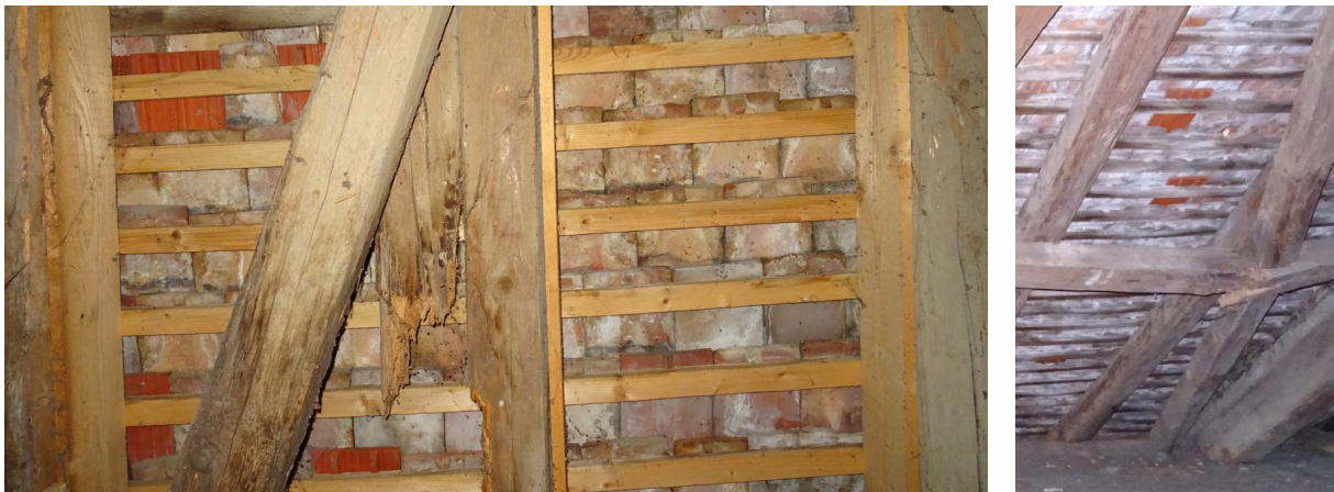
Abb. 317: Bruchstellen im Dachstuhl
