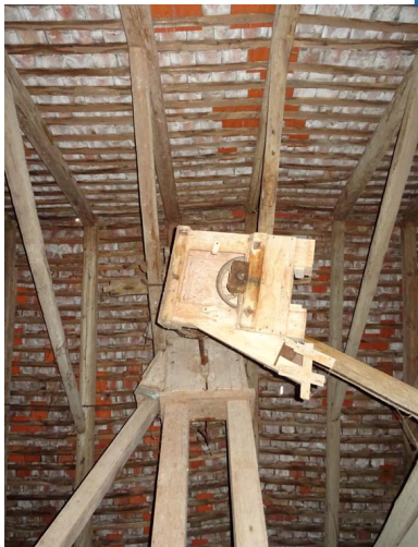
Abb. 306: Elevator, oberes Ende
