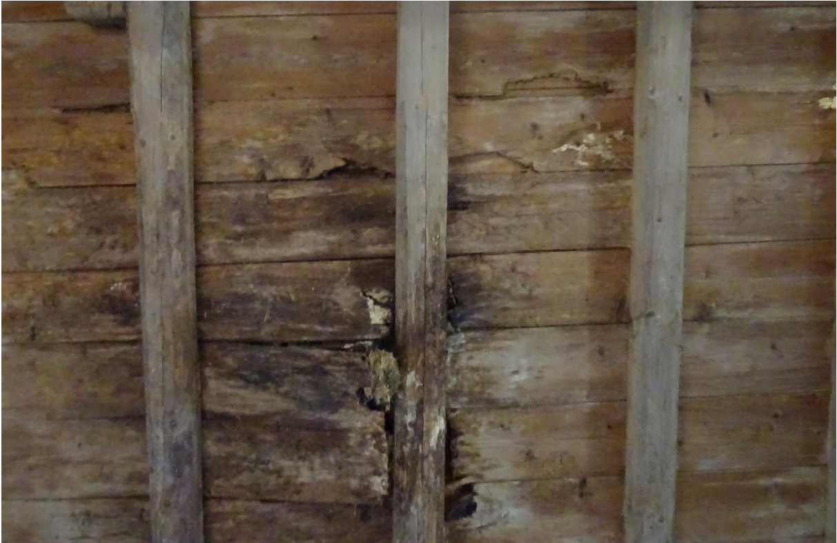
Abb. 133: Verrottete Holzdielen und Holzbalken in der Decke des Raumes 1.3
