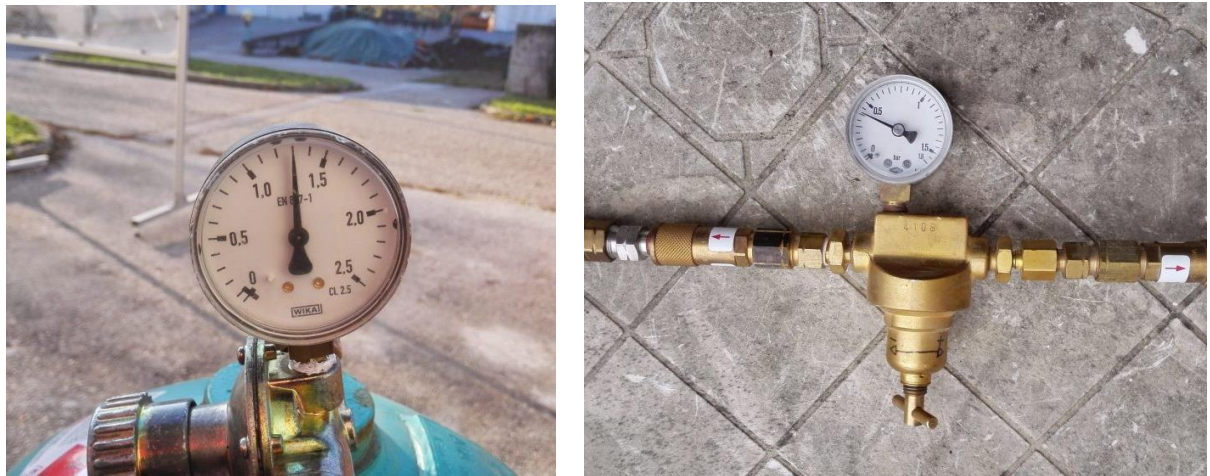
Abbildung 28: Messanzeige des Gasdrucks an der Propangasflasche, Einstellung > 1bar (links) und Messanzeige am Gasdruckregler, übliche Einstellung zwischen 0.5 und 1 bar (rechts)
